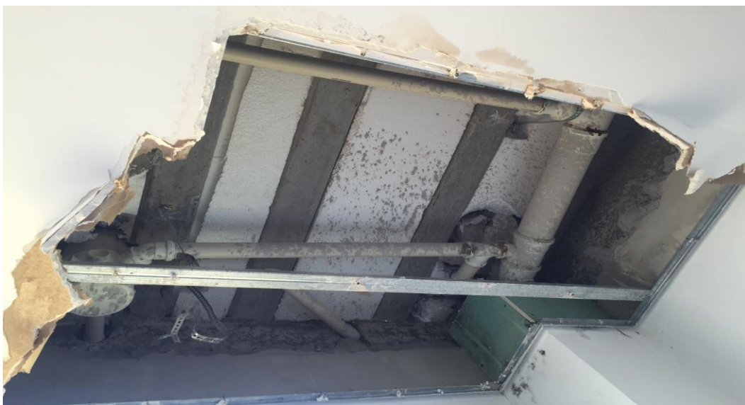
Figura 85 – Abertura no forro de gesso que apresentava umidade para conserto da tubulação do banheiro do andar superior
