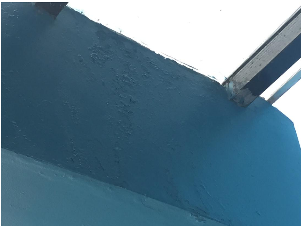
Figura 124 – Manchas de umidade e bolhas na pintura da estrutura do pórtico junto à conexão com a cobertura de policarbonato no acesso ao prédio
