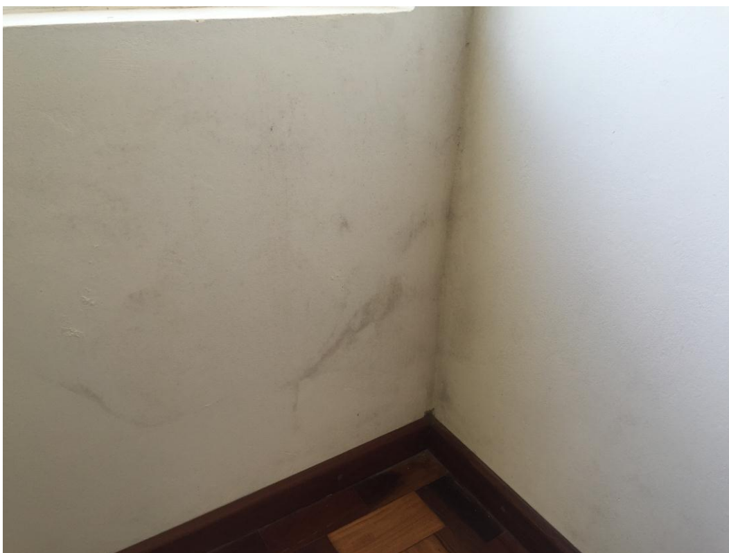
Figura 74 – Mofo no canto da parede adjacente à fachada leste
