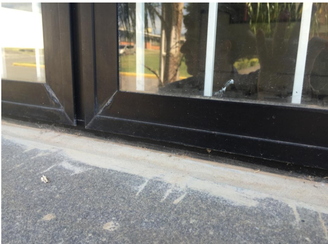
Figura 114 – Detalhe da pedra do peitoril cuja largura é insuficiente, havendo fechamento do vão com argamassa
