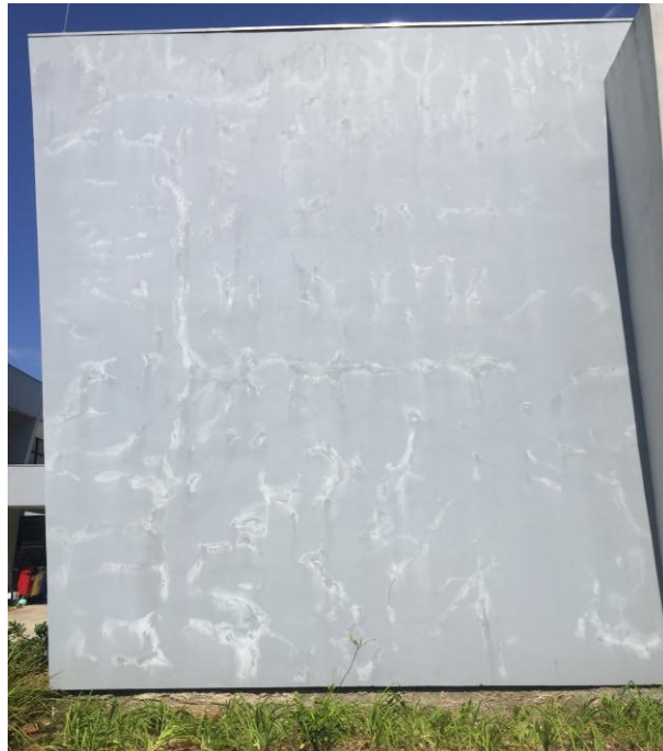
Figura 55 – Detalhe de aspecto fissurado da fachada frontal (leste)
