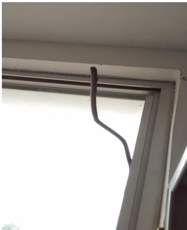
Figura 47 – Elemento de estanqueidade deslocado
