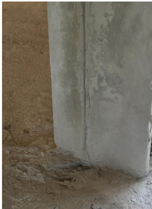
Figura 95 – Junta de dilatação com fissura na coluna e no piso preenchida com contrapiso
