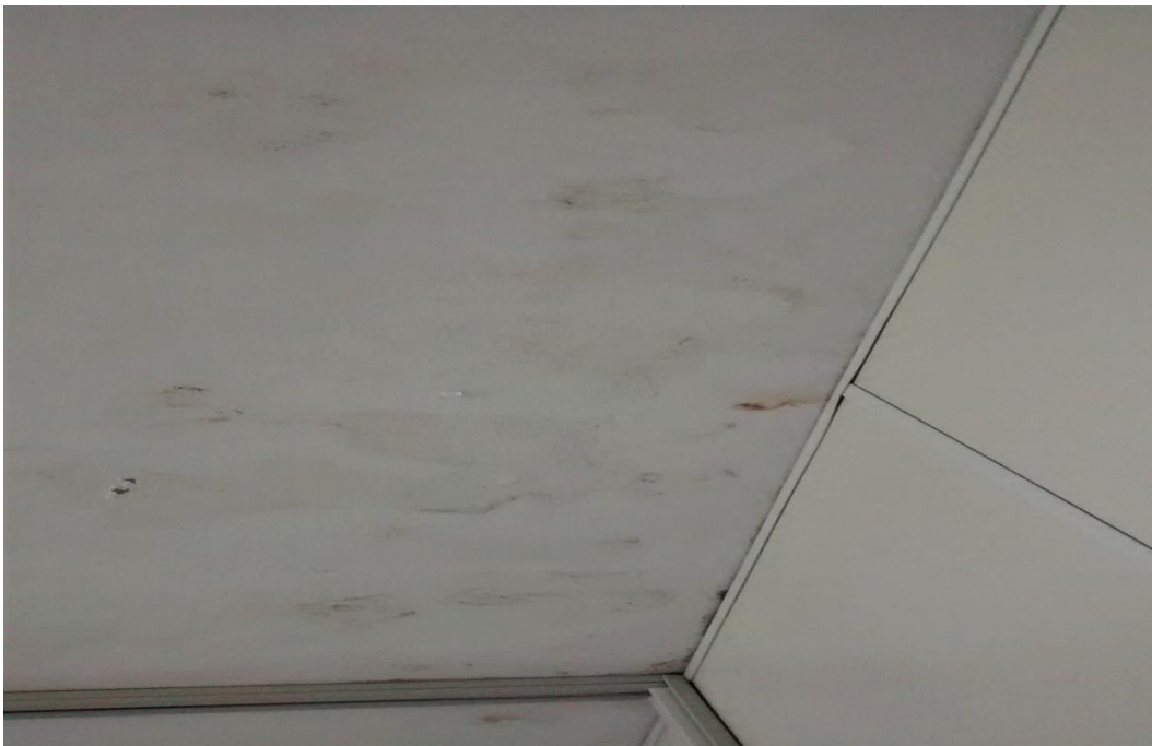
Figura 61 – Mofo e manchas de umidade em sala do segundo pavimento
