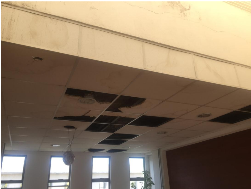
Figura 99 – Desprendimento de placas do forro do último pavimento
