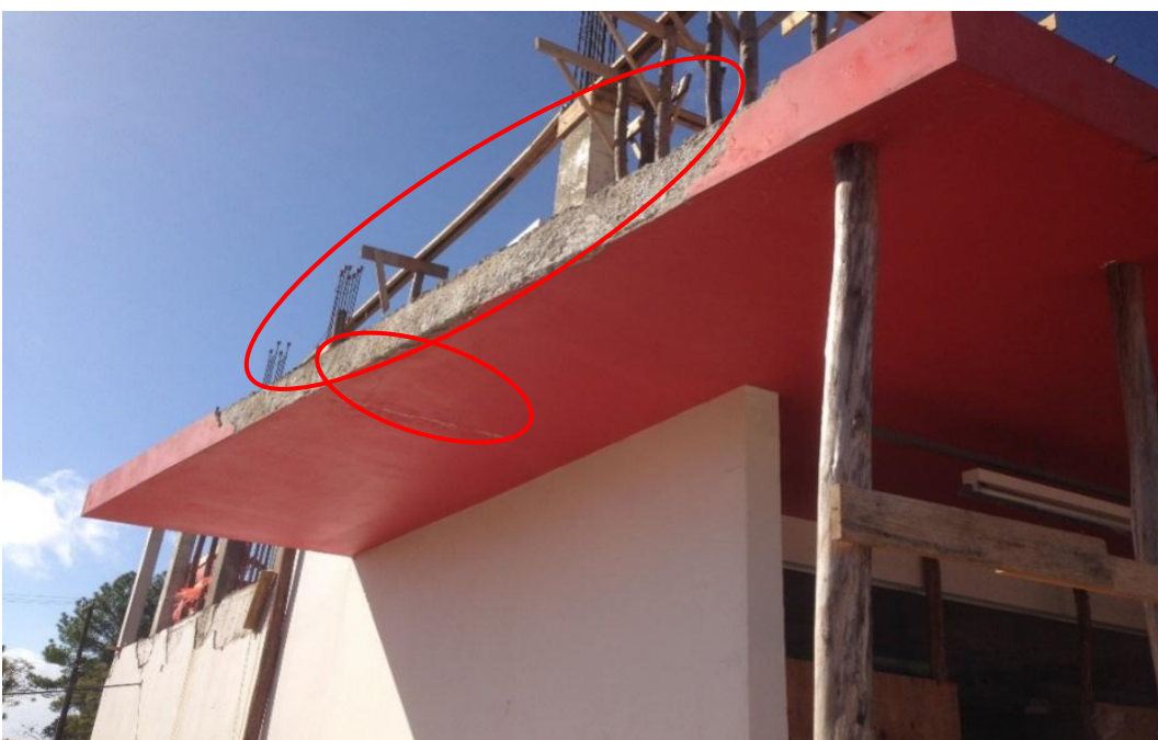
Figura 26 – Fissura e desprendimento de revestimento na marquise
