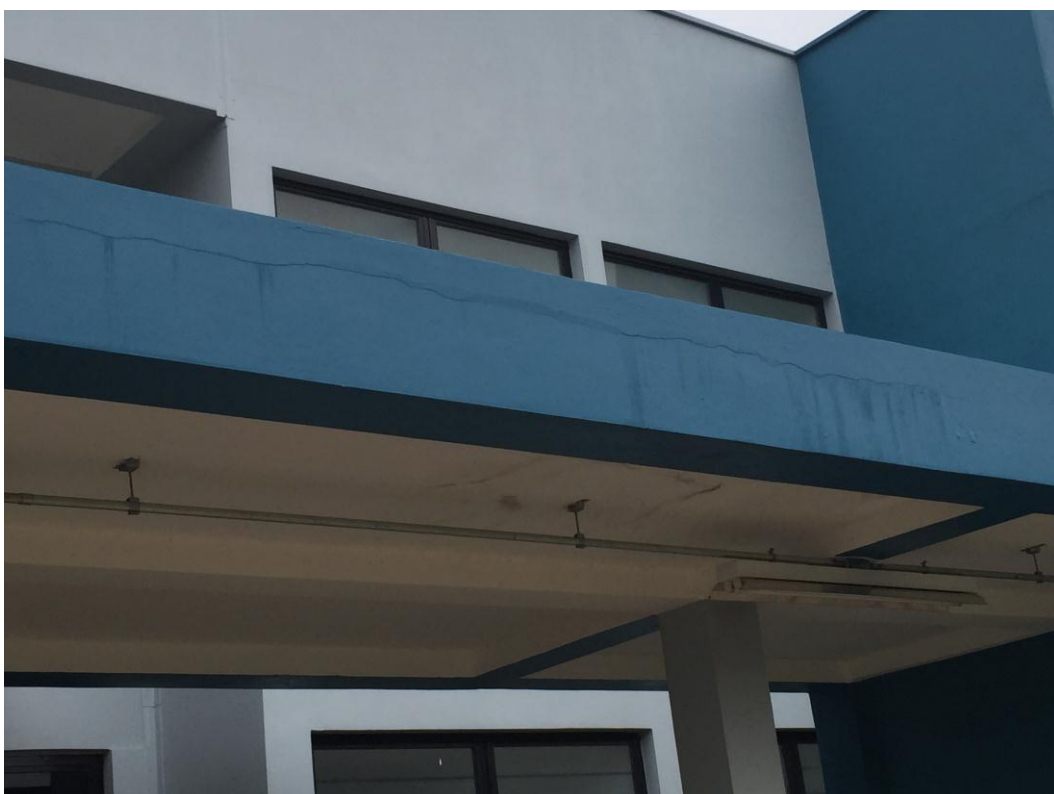
Figura 121 – Detalhe da fissura e umidade da laje de cobertura
