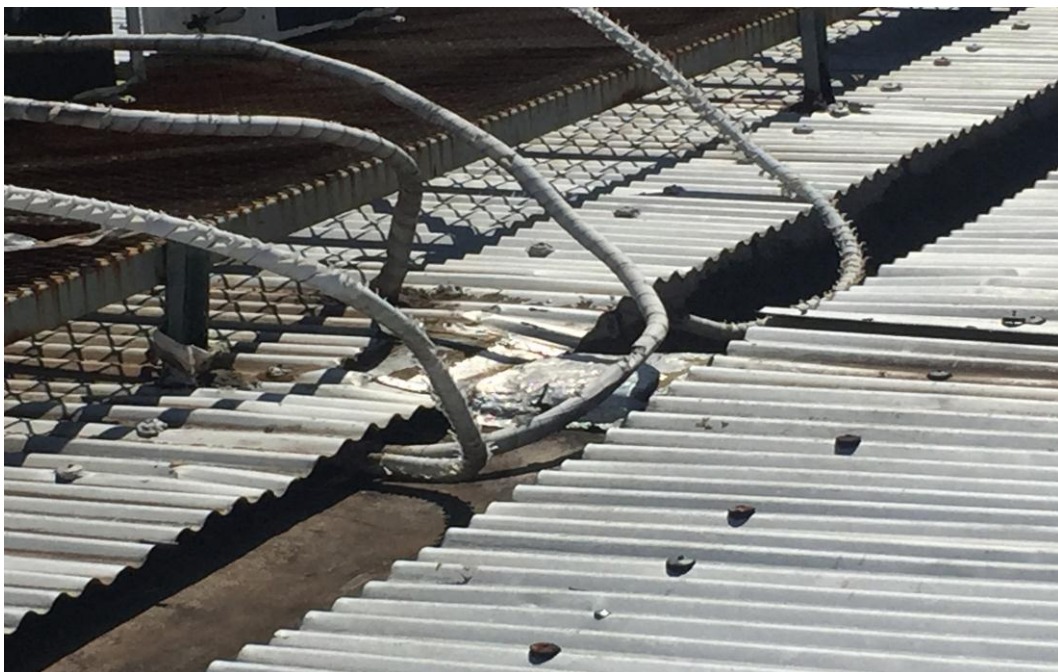
Figura 59 – Detalhe da cobertura danificada e tubulações de ar condicionado
