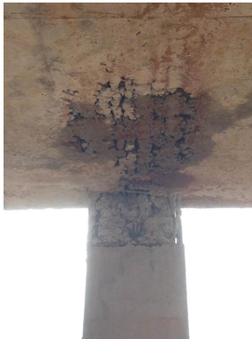
Figura 37 – Laje e pilar com falha de concretagem
