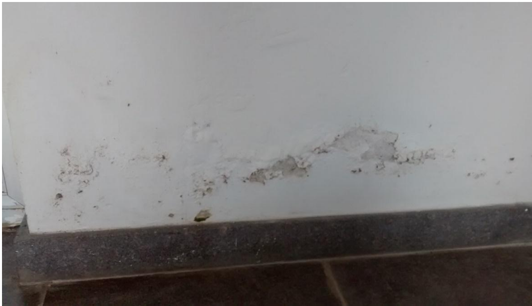
Figura 49 – Umidade ascensional com desprendimento da pintura (pavimento térreo)
