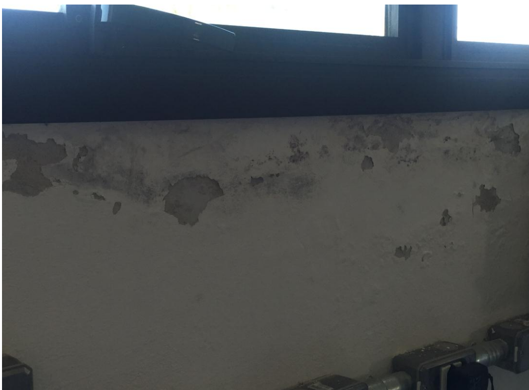
Figura 115 – Bolhas e descascamento da pintura em parede interna em região do peitoril da esquadria
