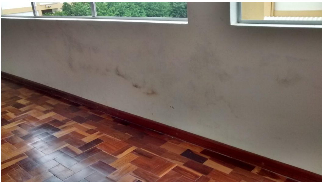
Figura 82 – Mofo na parede sul
