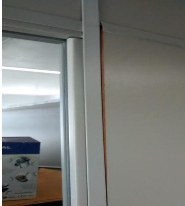
Figura 66 – Inchaço de elemento de divisória por presença de água
