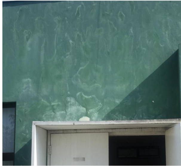
Figura 106 – Eflorescência no revestimento da fachada sul
