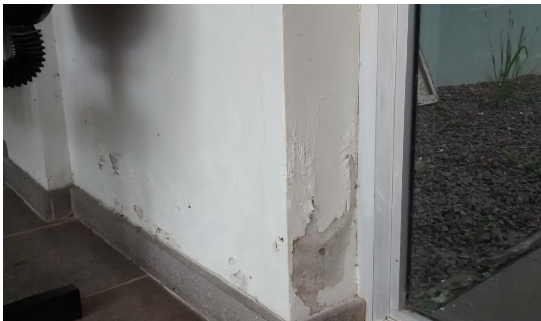
Figura 48 – Umidade ascensional com desprendimento da pintura (pavimento térreo)
