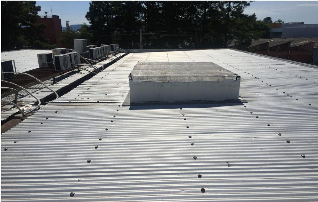
Figura 58 – Telhado em aluzinc com pouca inclinação
