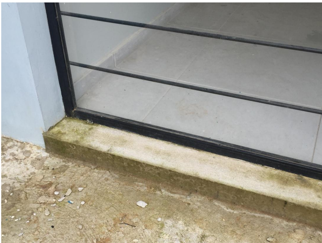
Figura 126 – Esquadria sem soleira e reboco sem proteção de pintura apresentando acúmulo de umidade e manchas de mofo
