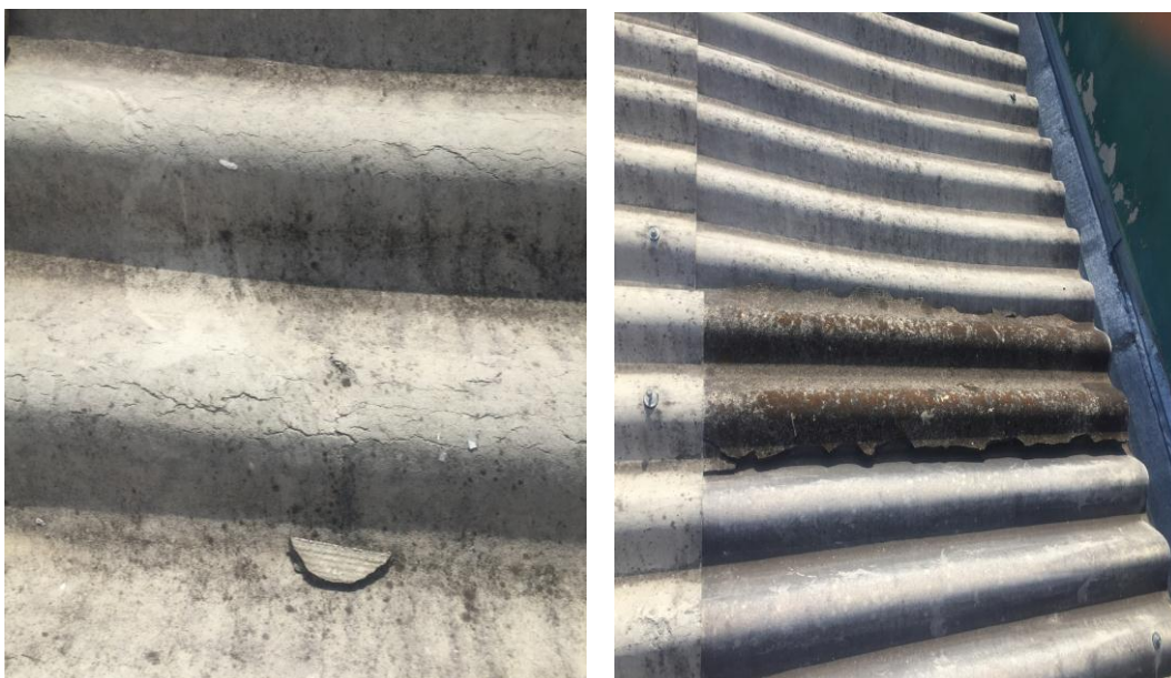
Figura 101 – Detalhe das telhas de fibrocimento em estado de decomposição
