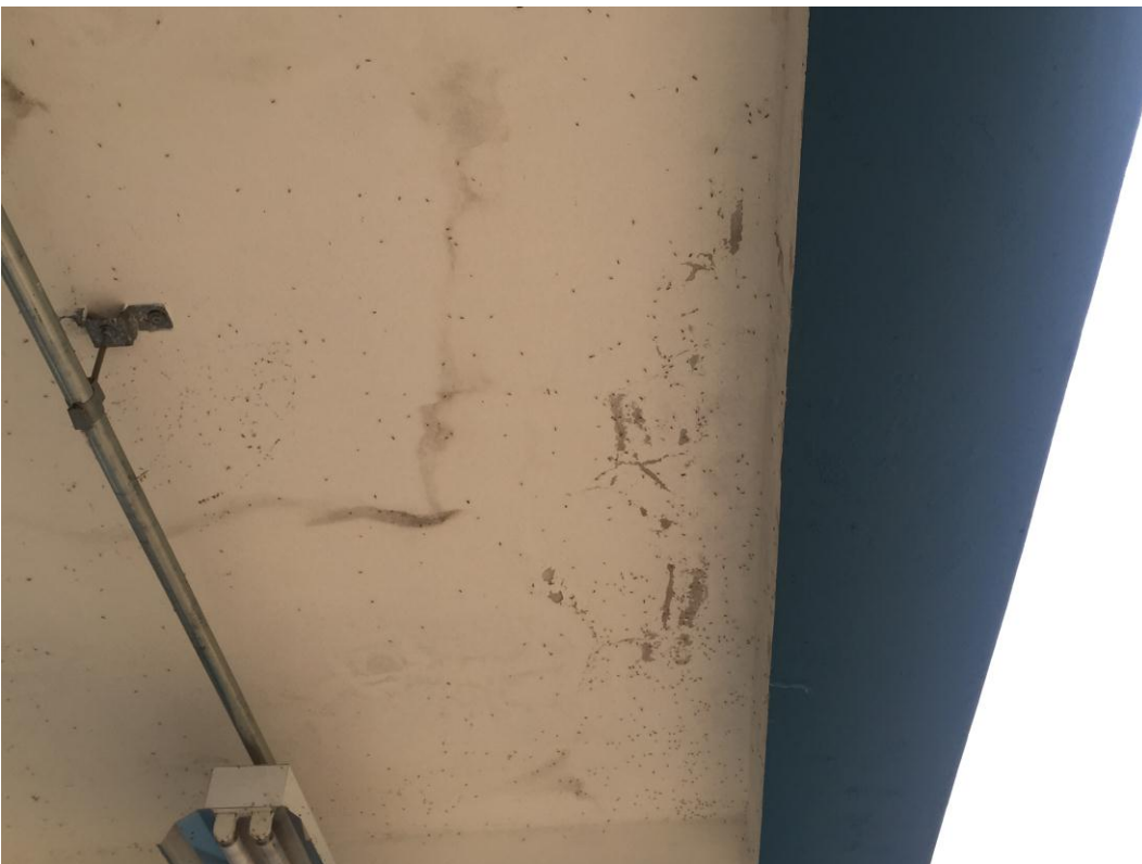
Figura 123 – Infiltração na laje de cobertura do pórtico
