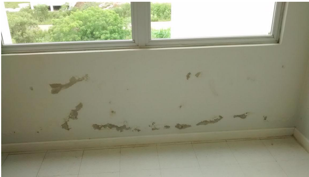
Figura 50 – Umidade na parede provoca desprendimento da camada de pintura
