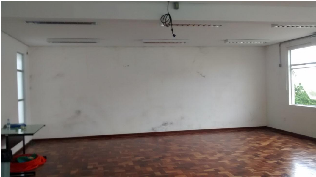
Figura 75 – Mofo em parede leste
