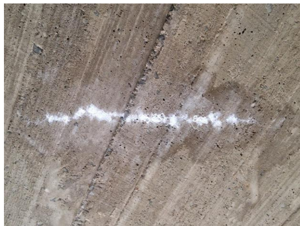
Figura 14 – Eflorescência no concreto
