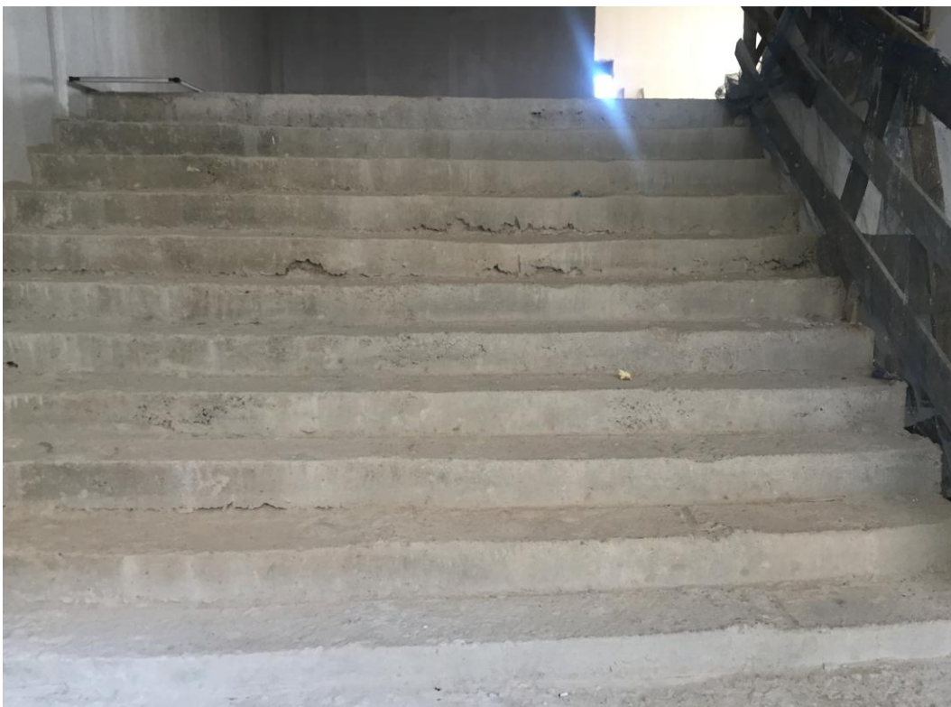
Figura 91 – Detalhe da escada com degraus tortos e nichos de concretagem
