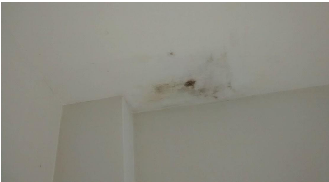
Figura 52 – Presença de umidade no teto
