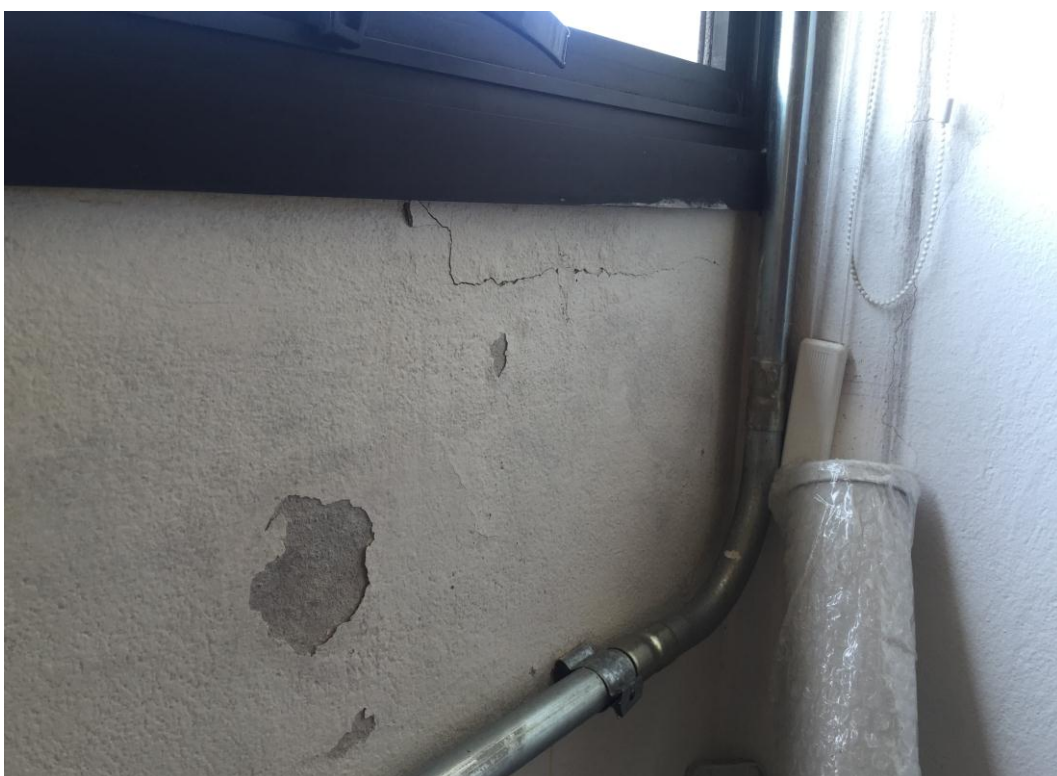
Figura 117 – Fissura e desprendimento da camada de pintura em parede interna em região próxima à esquadria
