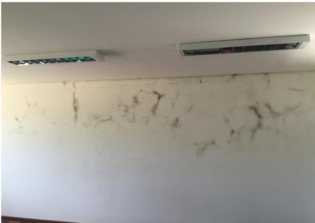
Figura 73 – Mofo em parede adjacente à fachada leste
