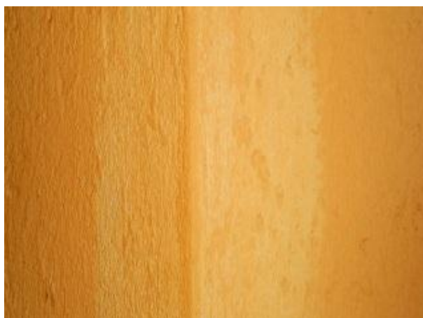
Figura 11 – Manchas na pintura
