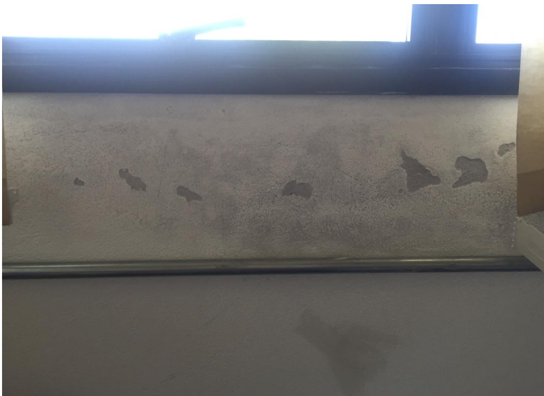
Figura 116 – Manchas de umidade e descascamento da pintura em revestimento interno junto à esquadria
