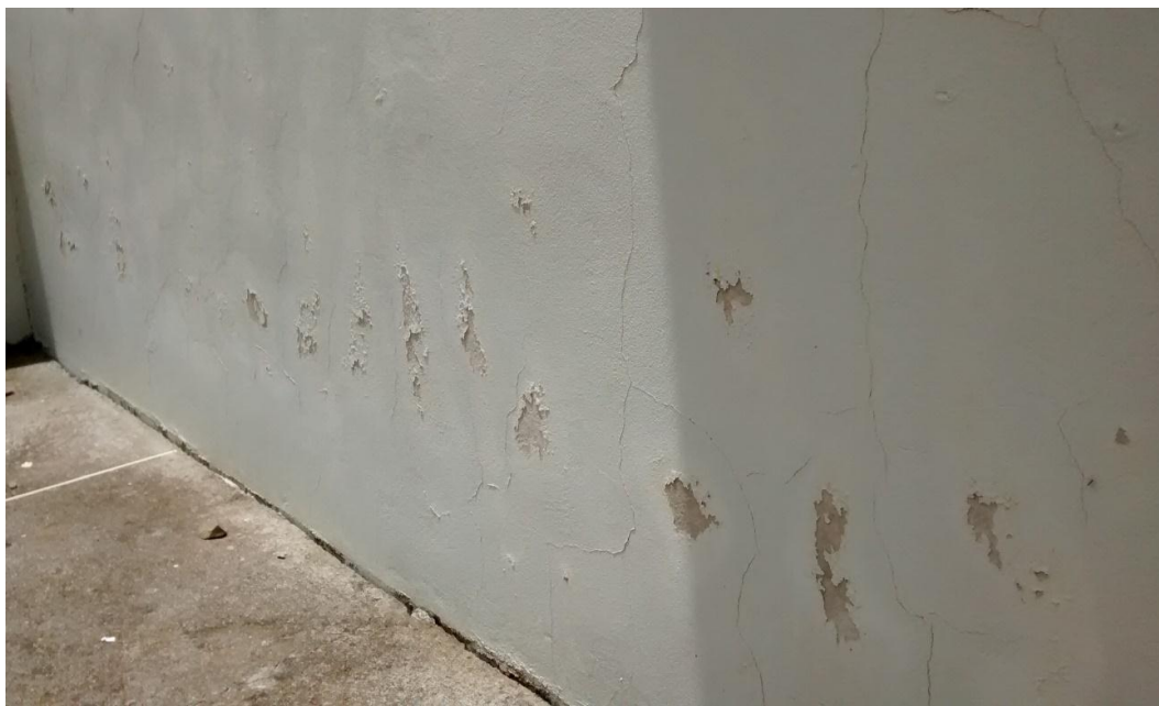
Figura 39 – Fissuras e perda de aderência da camada de pintura
