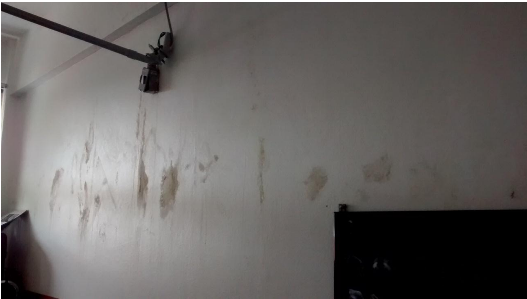
Figura 65 – Mofo em parede de sala junto à fachada frontal
