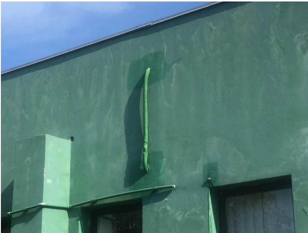
Figura 107 – Eflorescência no revestimento da fachada sul
