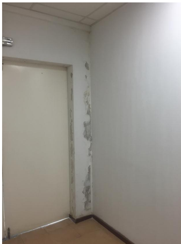
Figura 108 – Desagregação da pintura em razão da presença de umidade – parede junto à fachada sul
