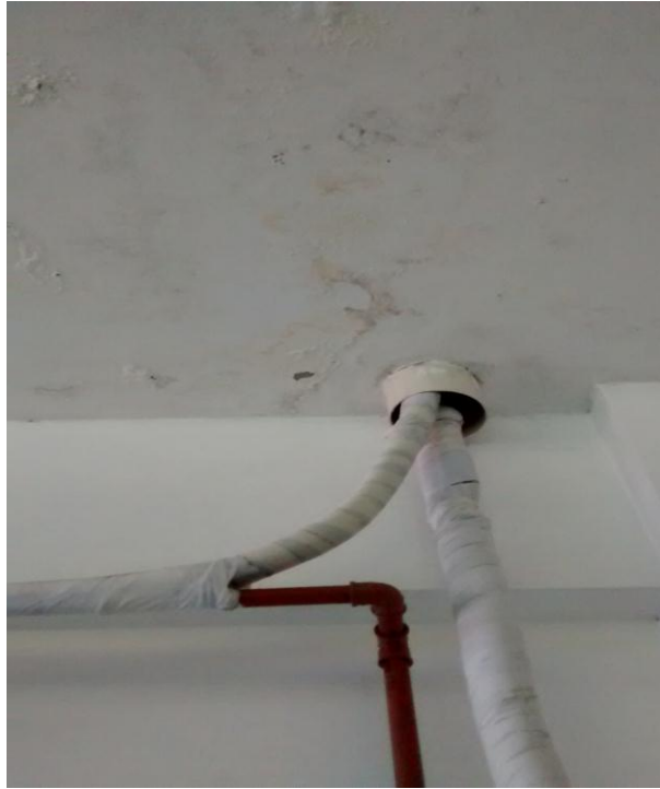
Figura 64 – Mofo, bolhas e descascamento de tinta próximo à canalização de passagem dos tubos do ar-condicionado
