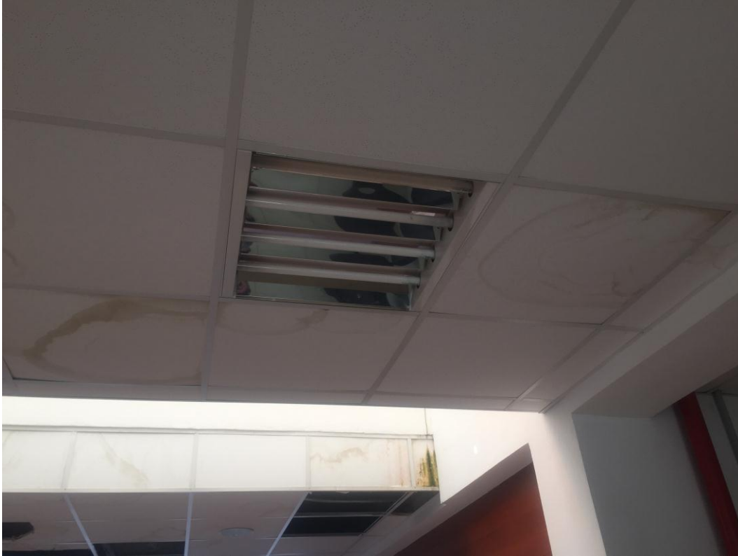
Figura 98 – Manchas de umidade no forro do último pavimento
