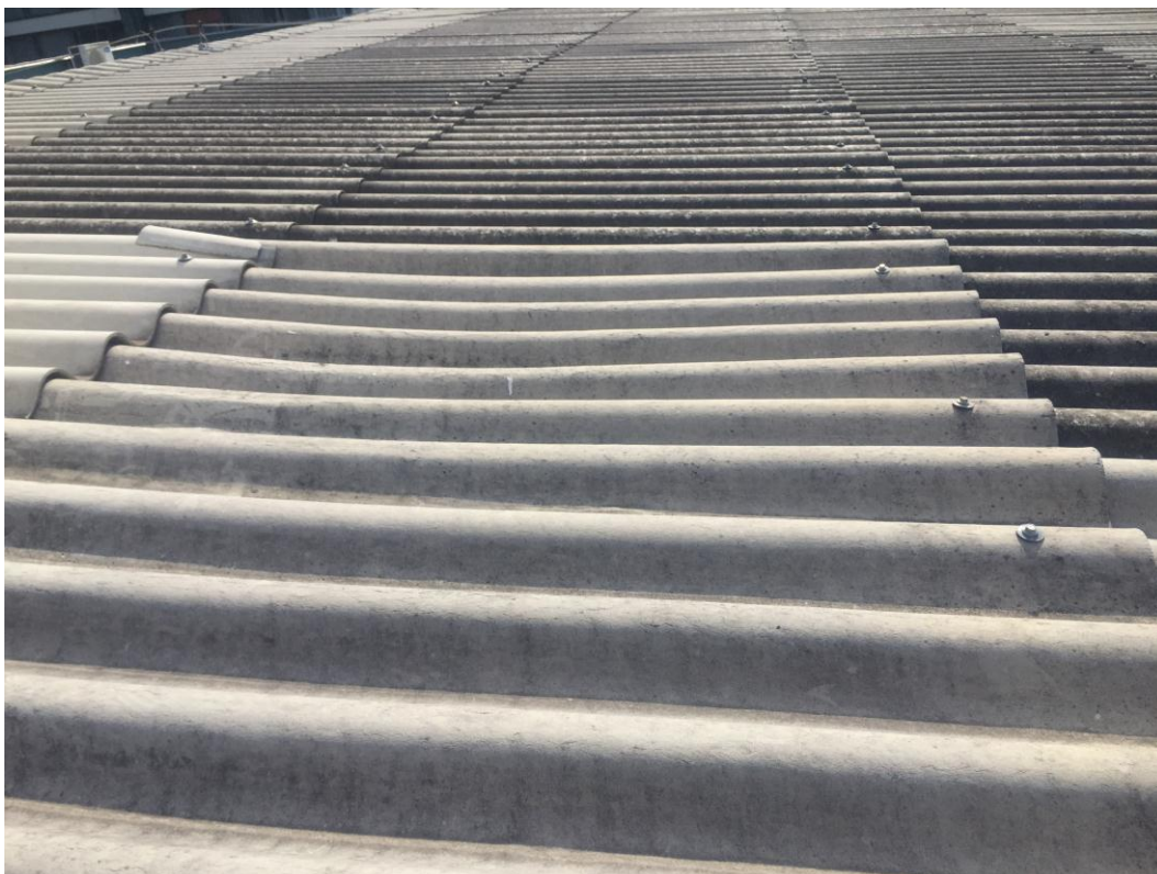
Figura 100 – Detalhe do telhado com deformação de sua estrutura de madeira
