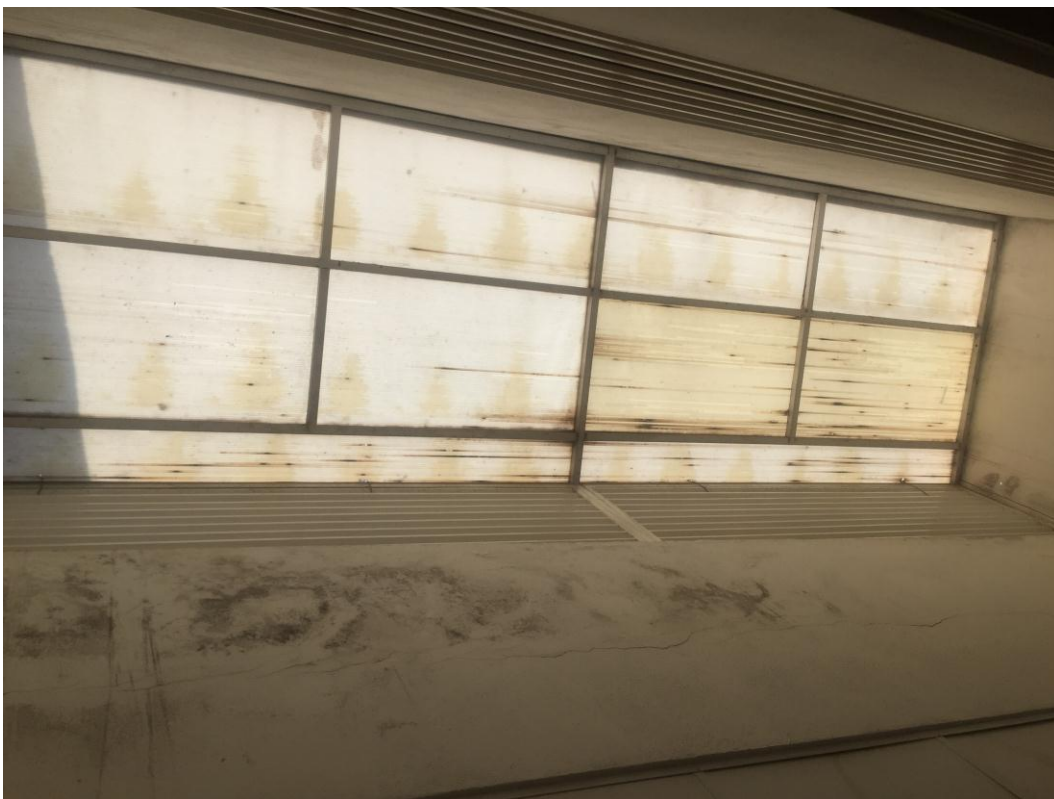
Figura 103 – Manchas de umidade devido à infiltração pela cobertura de policarbonato
