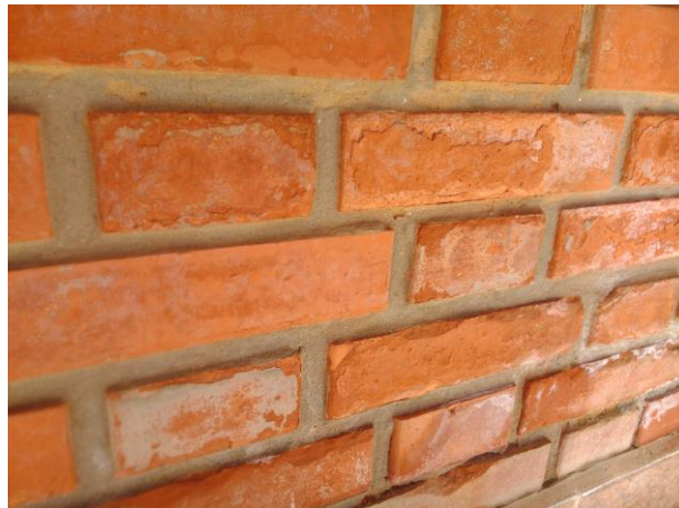
Figura 13 – Eflorescência na alvenaria
