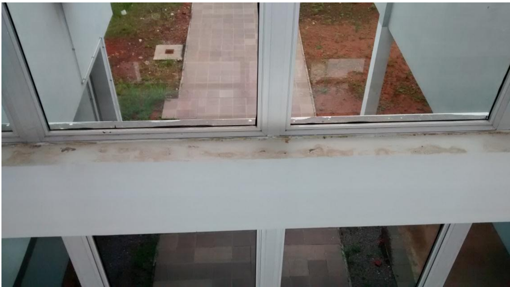
Figura 51 – Problema de estanqueidade/presença de umidade interior
