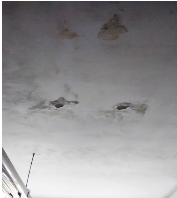
Figura 57 – Descascamento da pintura e mofo em sala do segundo pavimento
