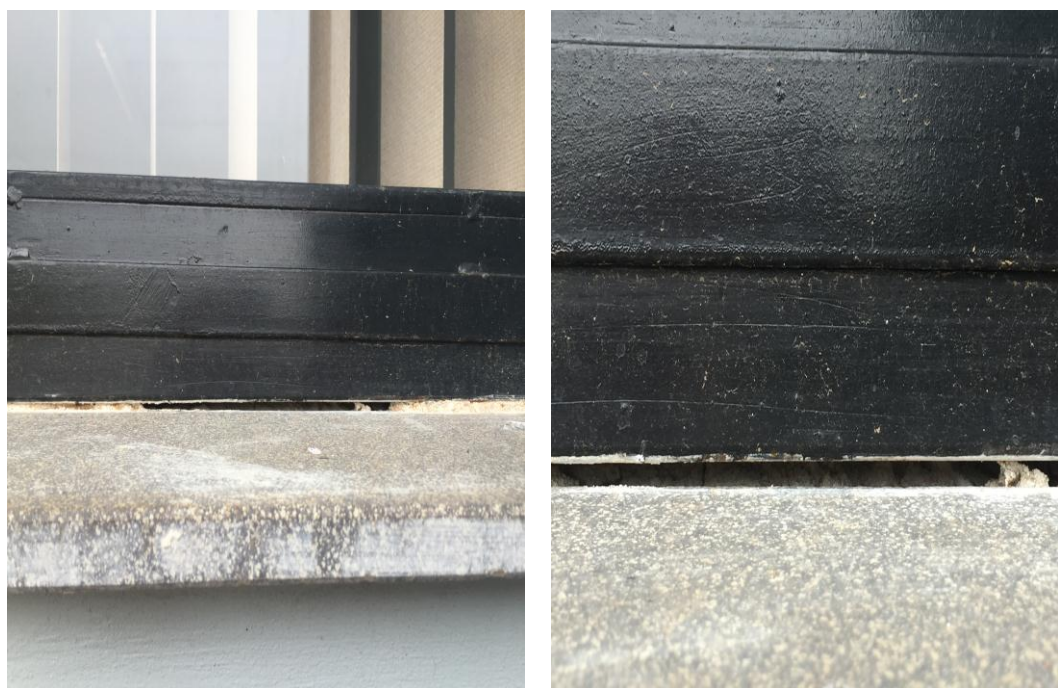
Figura 125 – Vãos entre as soleiras e as esquadrias
