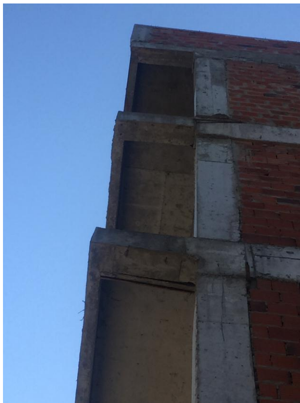
Figura 89 – Detalhe de problemas de concretagem na estrutura do prédio
