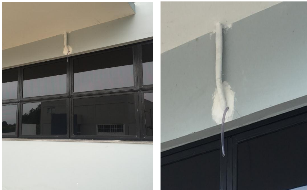
Figura 128 – Detalhe da instalação de ar condicionado sem qualquer planejamento
