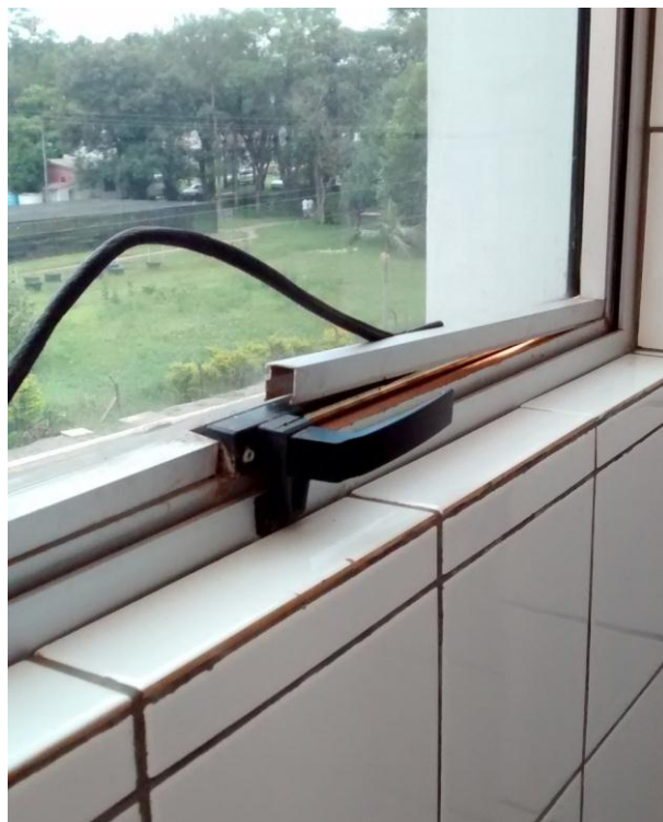
Figura 46 – Elemento de estanqueidade deslocado
