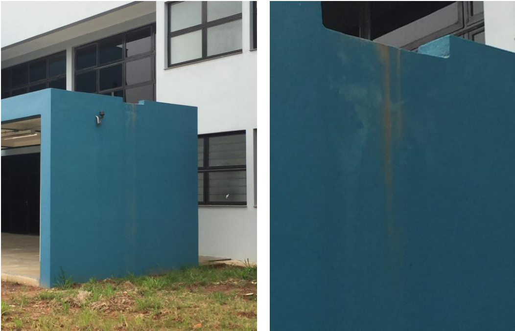
Figura 122 – Manchas de umidade no pórtico
