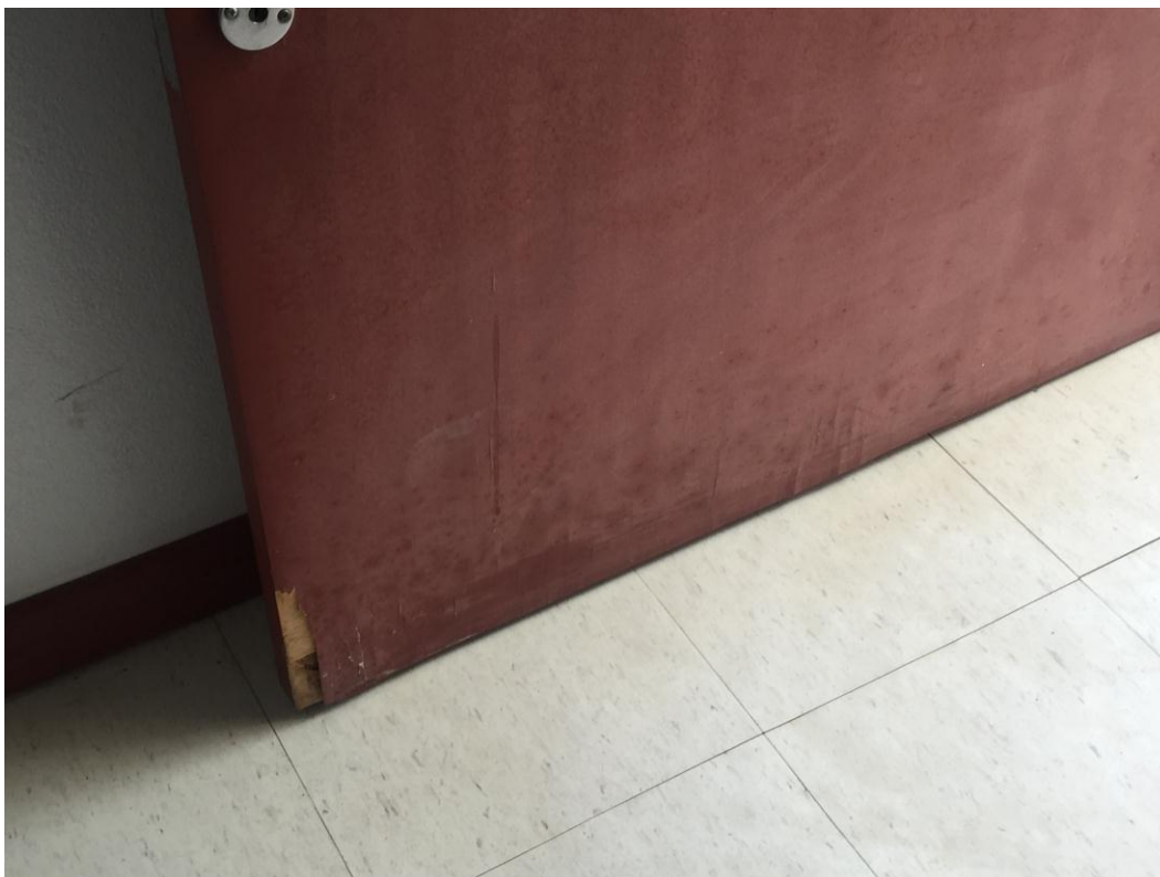
Figura 118 – Deterioração de porta junto à circulação do prédio
