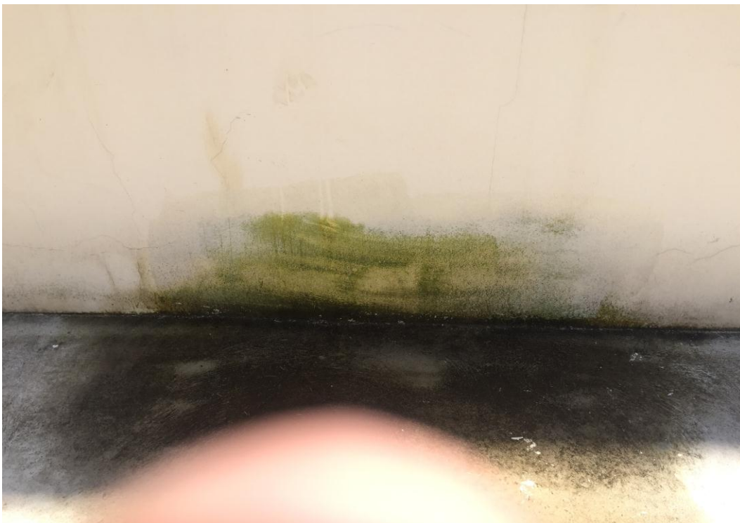
Figura 78 – Detalhe da umidade na parede externa devido à água proveniente do dreno do ar condicionado
