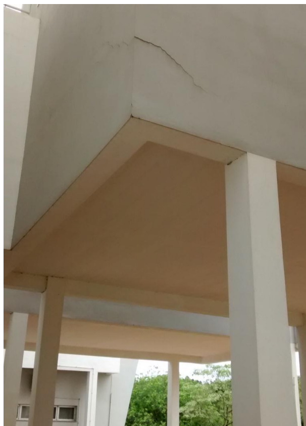
Figura 42 – Trinca a 45° em região de balanço
