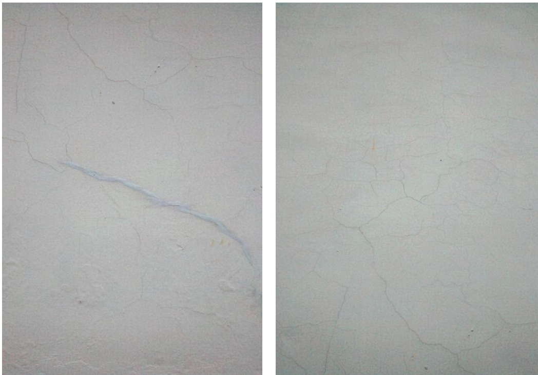
Figura 72 – Detalhes das fissuras da fachada leste
