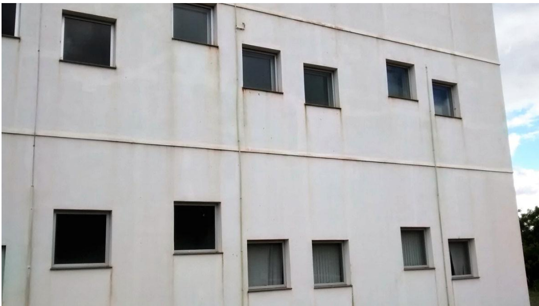
Figura 44 – Aspecto da fachada, pingadeiras
