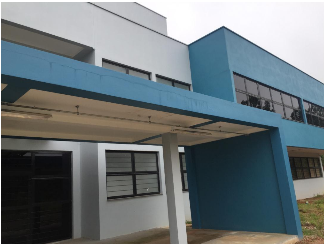
Figura 120 – Fissura no pórtico de acesso ao prédio
