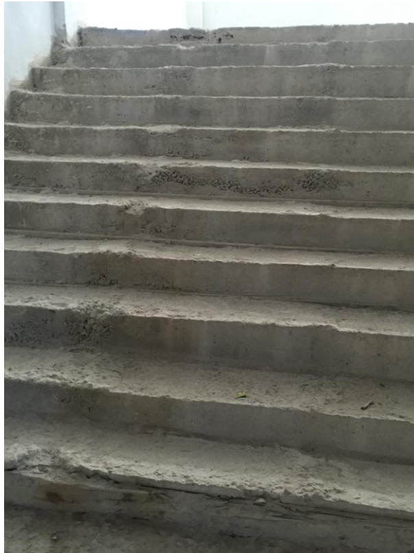
Figura 90 – Detalhe da má execução da escada
