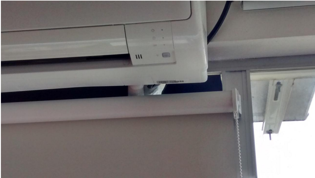
Figura 81 – Abertura não vedada para passagem de tubulação do ar-condicionado
