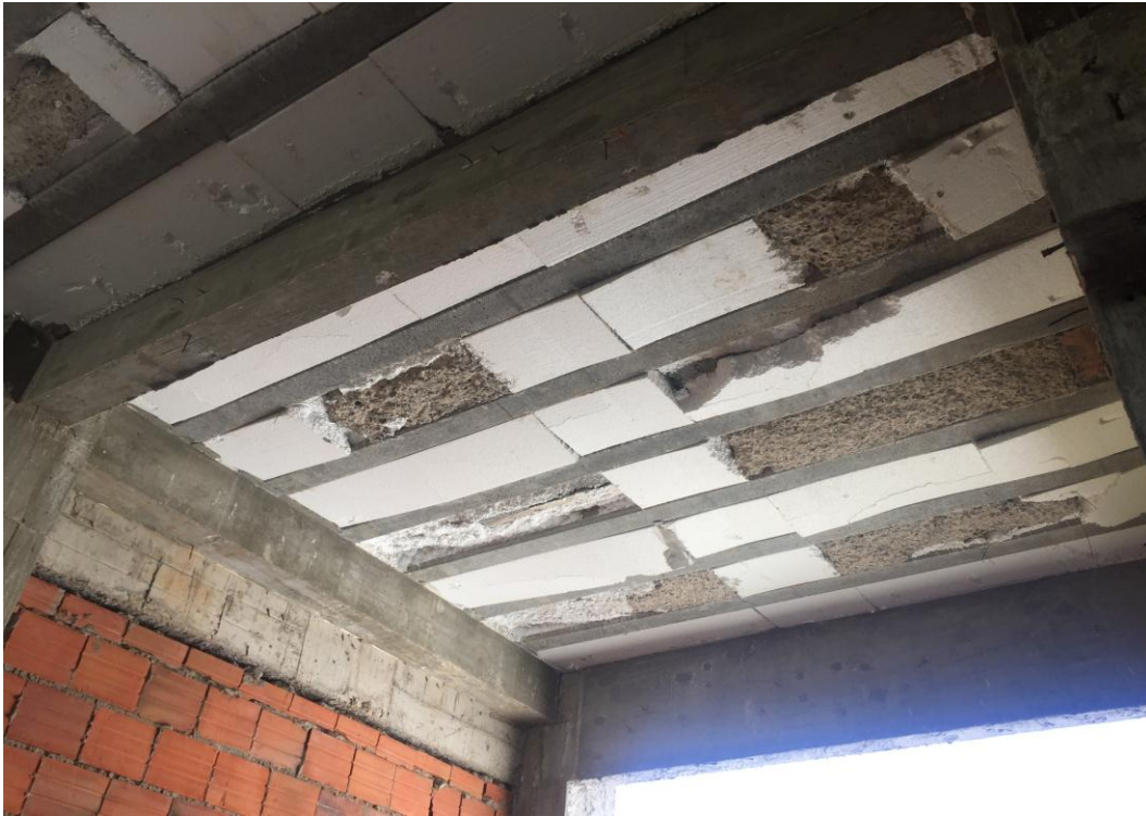
Figura 94 – Laje com problema de concretagem
