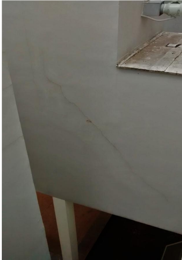
Figura 43 – Trinca a 45° podendo indicar recalque suave
