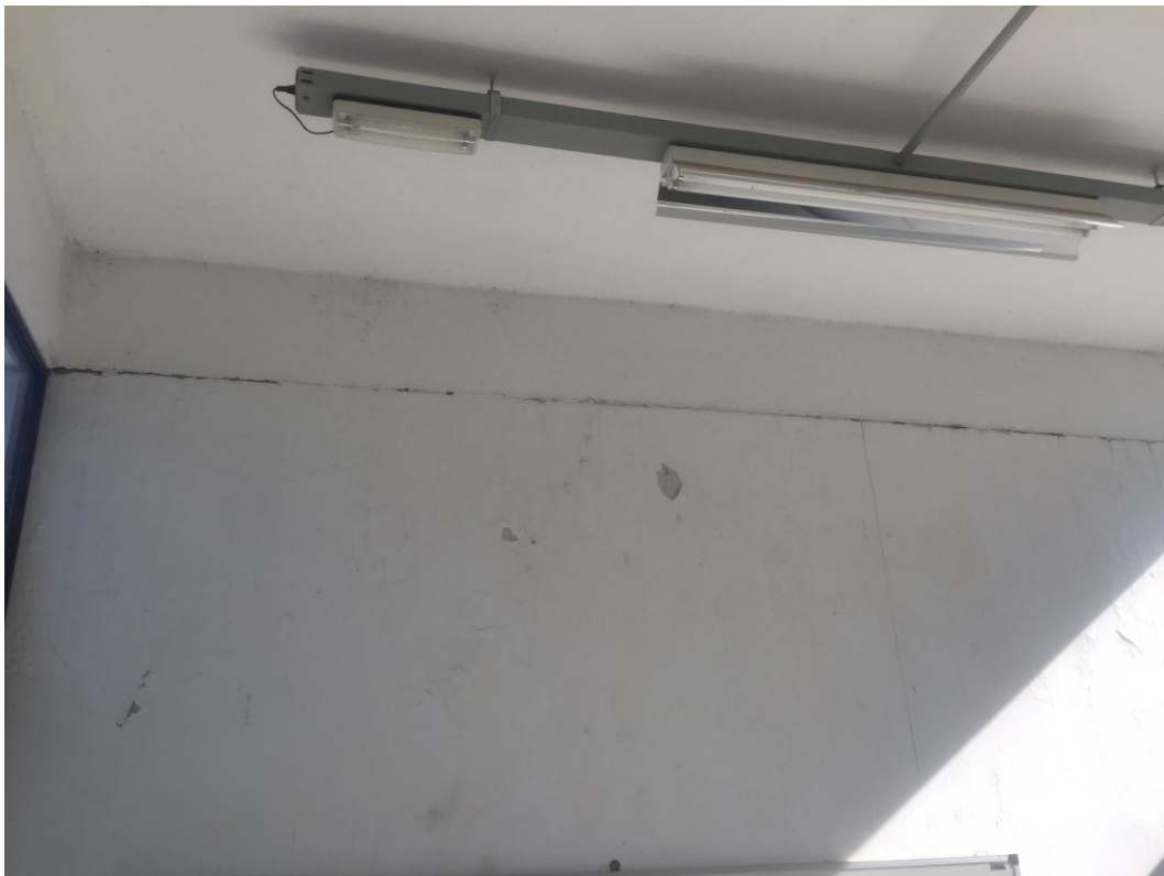
Figura 97 – Fissura entre alvenaria e viga de concreto
