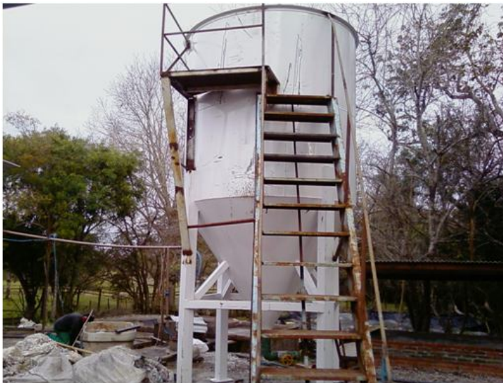
Figura 15 - Tanque cônico onde ocorre o processo físico-químico de tratamento.
