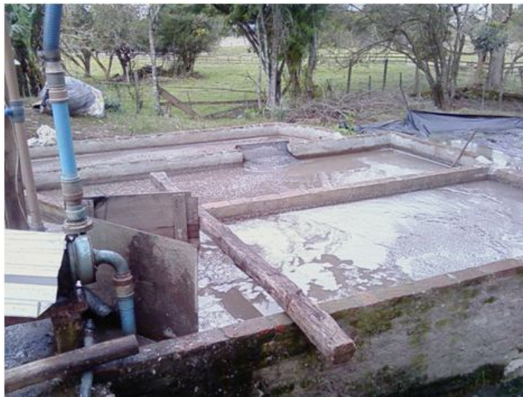
Figura 14 - Tanque de sedimentação do efluente.
