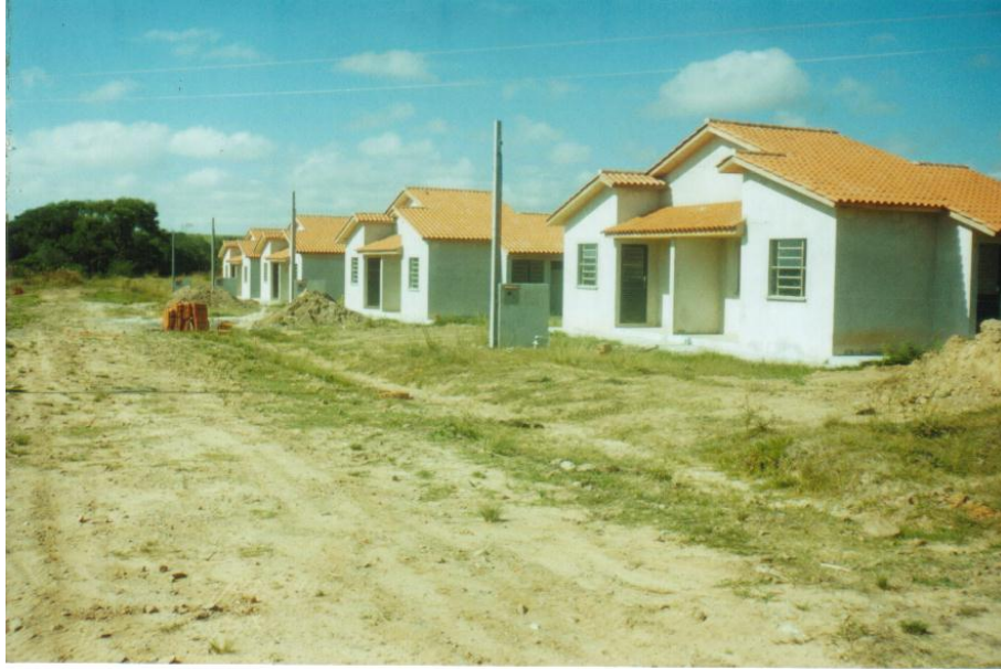
FIGURA 03: Vista de algumas casas geminadas, ainda em construção, do Loteamento Paróquia das Dores. A composição de telhados enriquece a perspectiva.
