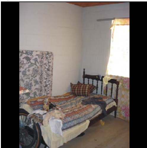
FIGURA 13: Vista B2.1. A cama em mau estado e o colchão utilizado para o casal dormir na sala.
