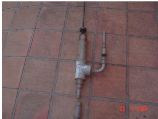
Figura 19 – Bomba em PVC (em funcionamento na estação 1 e na estação 2, nas localidades de Canabarro e UFSM – Santa Maria - RS.). (Fonte: Foto do autor).
