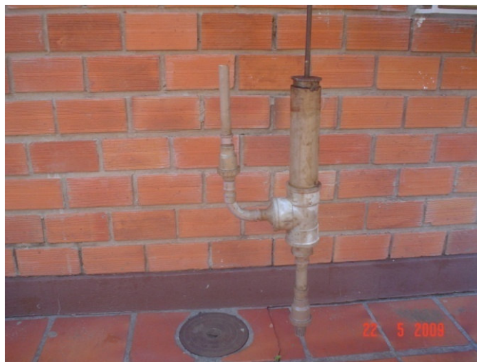
Figura 20 - Bomba em PVC (em funcionamento na estação 1 e na estação 2, nas localidades de Canabarro e UFSM – Santa Maria - RS.). (Fonte: Foto do autor).
