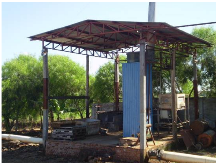
Figura 4.8 – Caldeira, utilizada para aquecimento de água. Fonte: Autora (2008).
