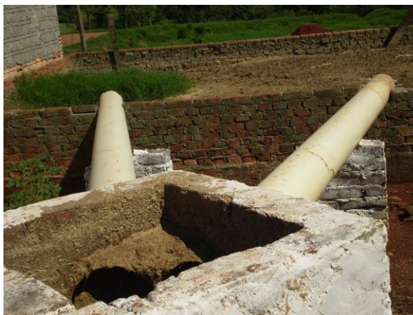
Figura 4.13 – Caixa de distribuição de estrume com estrumeiras no fundo. Fonte: Autora (2008).
