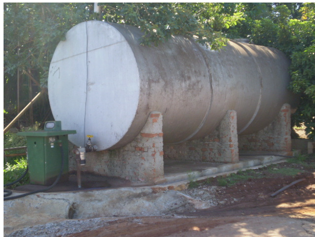
Figura 4.15 – Tanque de combustível próximo aos contêineres. Fonte: Autora (2008).
