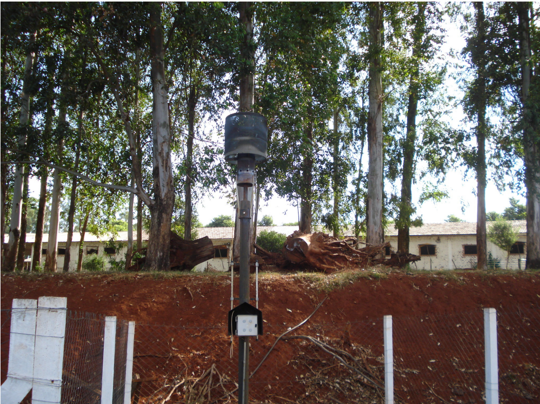
Figura 8 – Queimador do biogás ( flare ) Fonte: Arquivo do autor.
