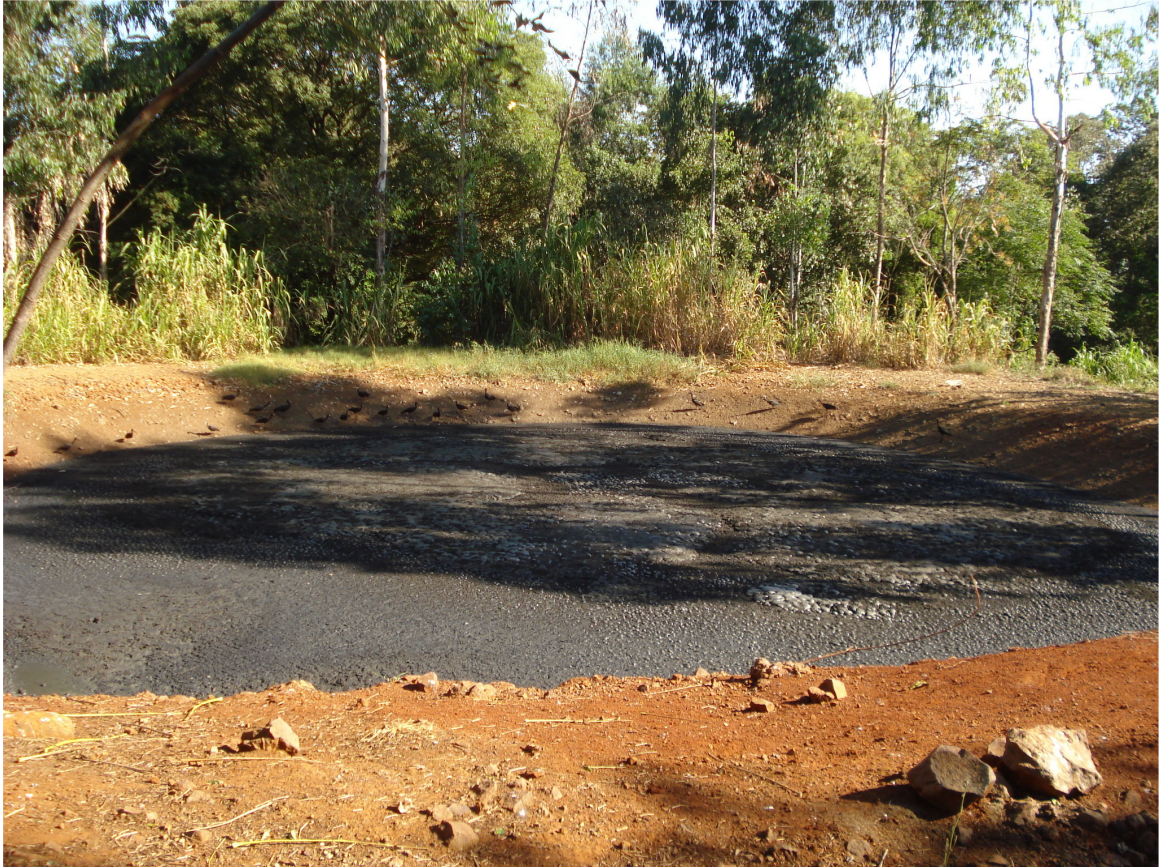
Figura 1 – Bioesterqueira de criação suína – Interior do município de Santa Rosa.
