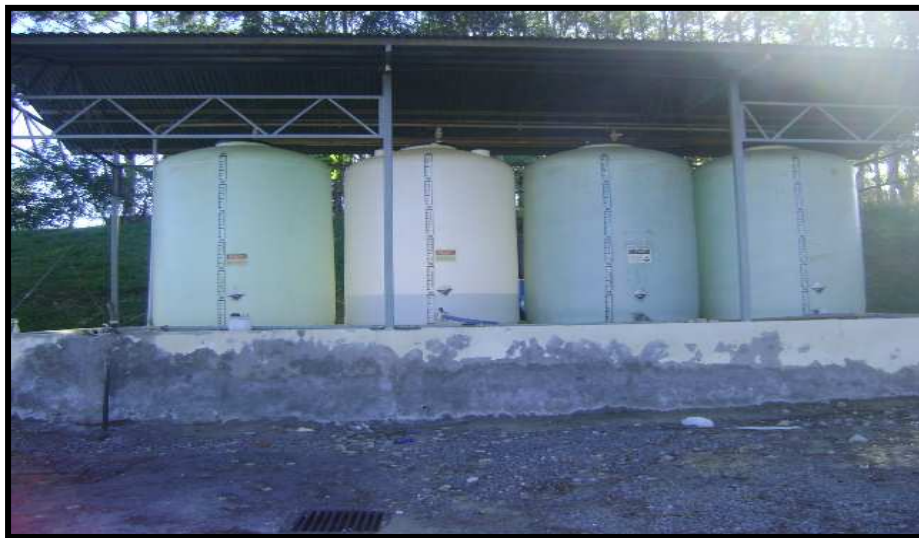
Figura 23 - Local de armazenagem do Hidróxido de Sódio
