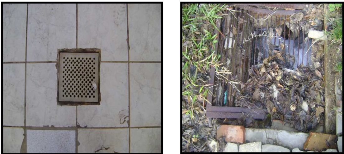
Figura 22 - Sistema de drenagem
