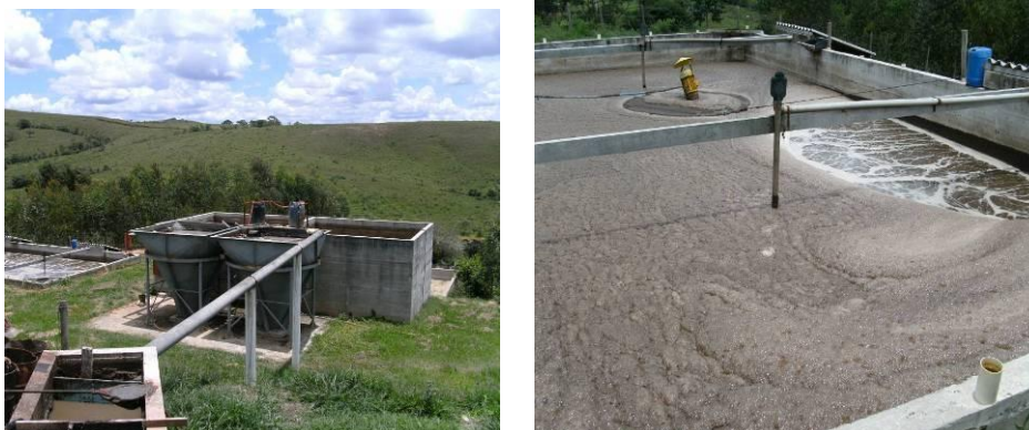
Figura 13 ó Centro de Tratamento de Efluentes de um Curtume de Dores de Campos/MG
