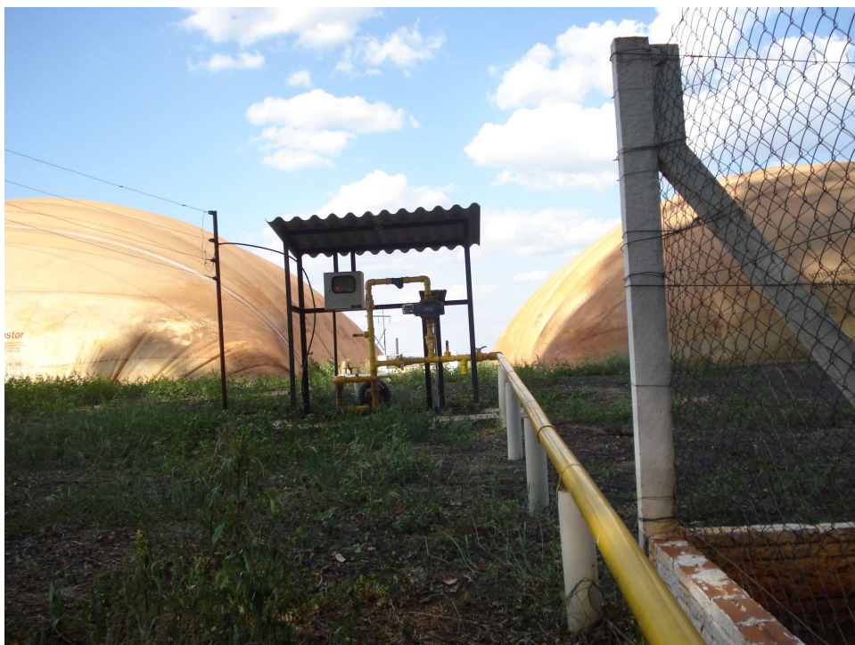
Figura 20 - Biodigestor Fonte: arquivo do autor
