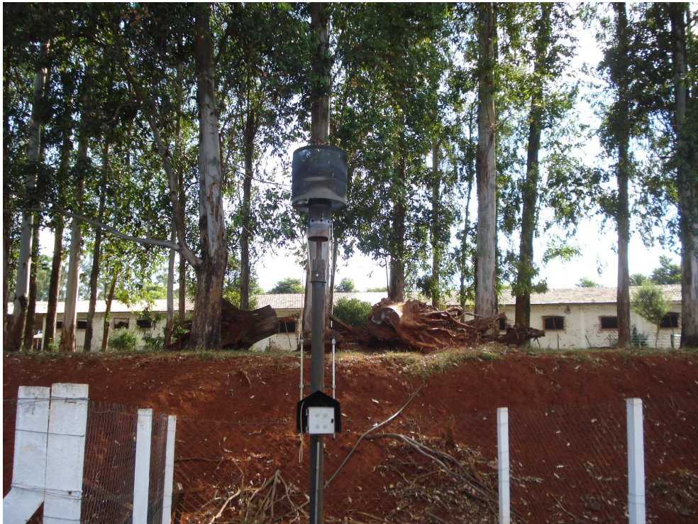
Figura 21 – Equipamento usado para queima do Biogás (flare) Fonte: arquivo do autor
