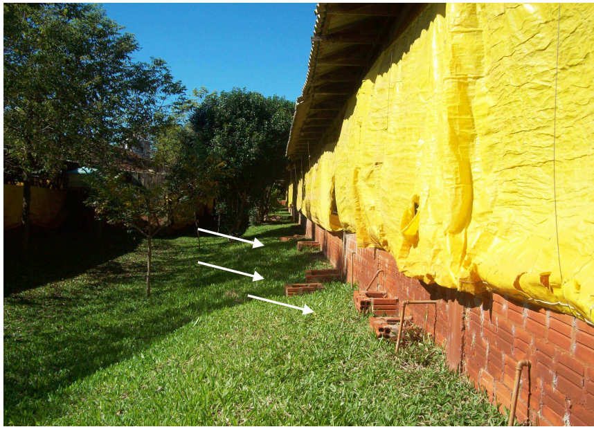
Figura 15 - Tubulação coletora de dejetos Fonte: Arquivo do Autor
