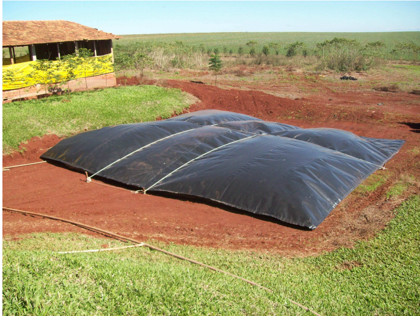
Figura 17 - Balão de armazenamento Fonte: Arquivo do Autor
