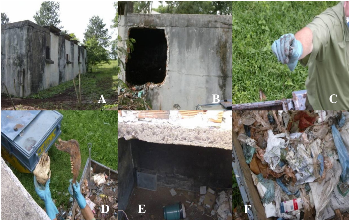
Figura 4.1 – Estrumeira inativa no HVU usada como depósito de resíduos
