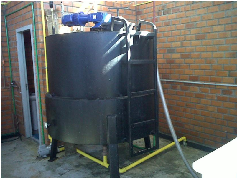
Figura 24 - Tanque de hidrólise Fonte: Arquivo do autor, 2011
