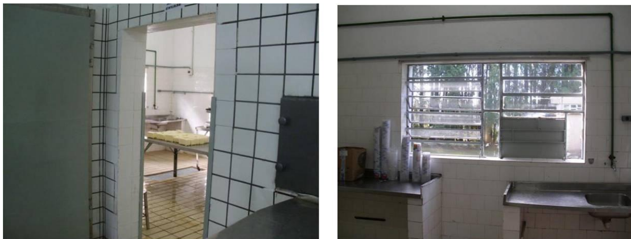
Figura 5 – Perdas térmicas no setor de envase de queijos: abertura no acesso (ausência de porta) e janela basculante
