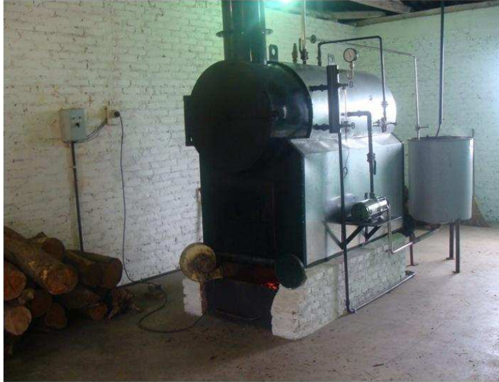
Figura 4.14- Ilustração a caldeira fogo tubular utilizada para geração de vapor.
