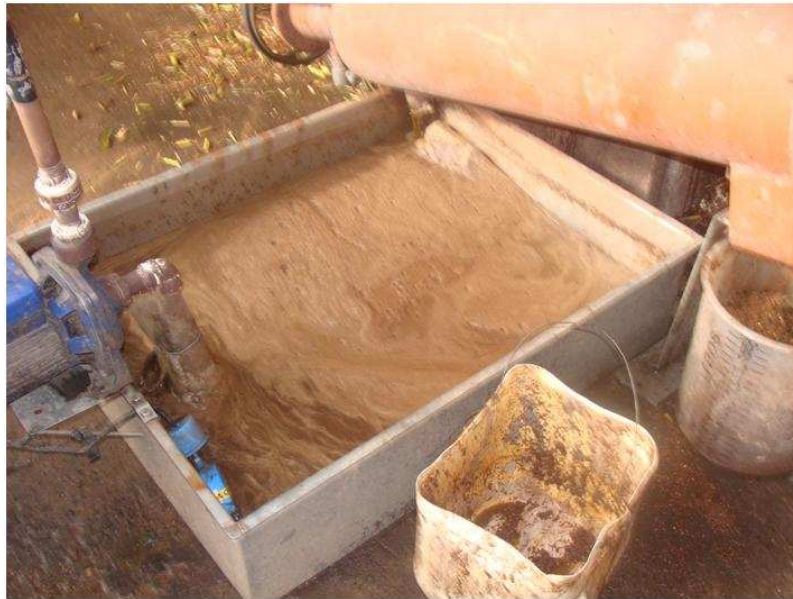
Figura 4.9- Sistema de separação de bagacilho e recalque do caldo para as dornas de fermentação.
