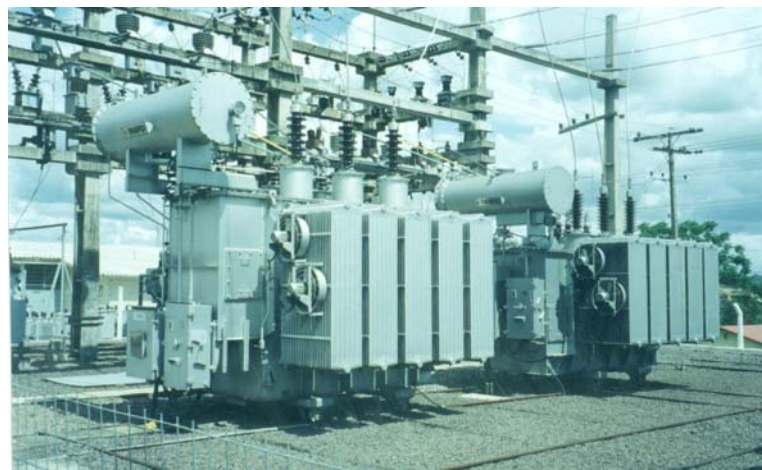
Figura 2.14 – Vista parcial de uma subestação rebaixadora Fonte: AGERGS (2001)
