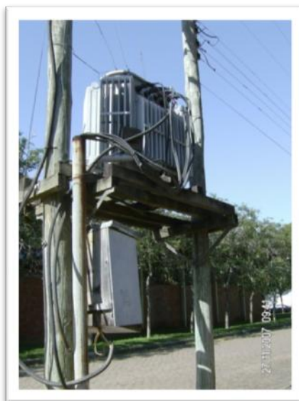
Figura 3.3 - Subestação em estado precário.
