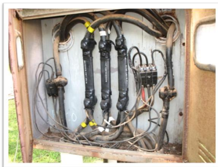
Figura 3.4 - QGBT fora dos padrões e sujeito a riscos.
