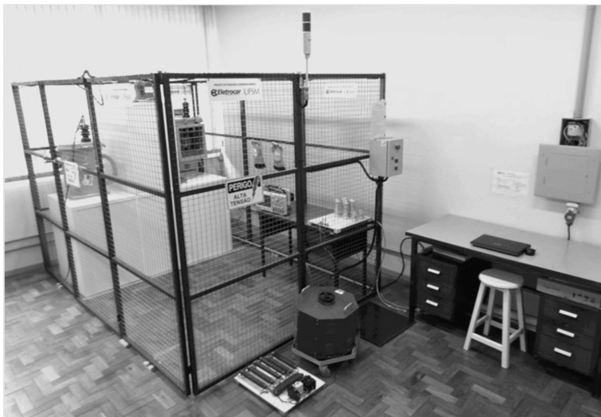
Figura D.1 – Laboratório de ensaios em média tensão.
