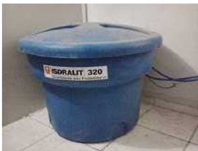
Figura B.6 – Reservatório de água em operação
