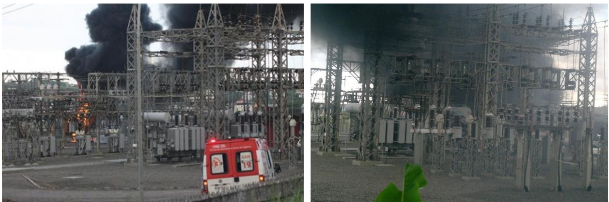
Figura 1 - Curto-circuito em um transformador na SE São Cristóvão/Coelba.
