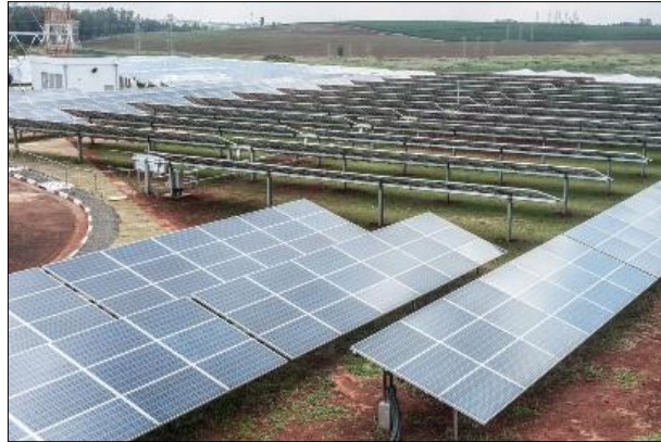
Figura 2.5 – Parque fotovoltaico em operação no Brasil
