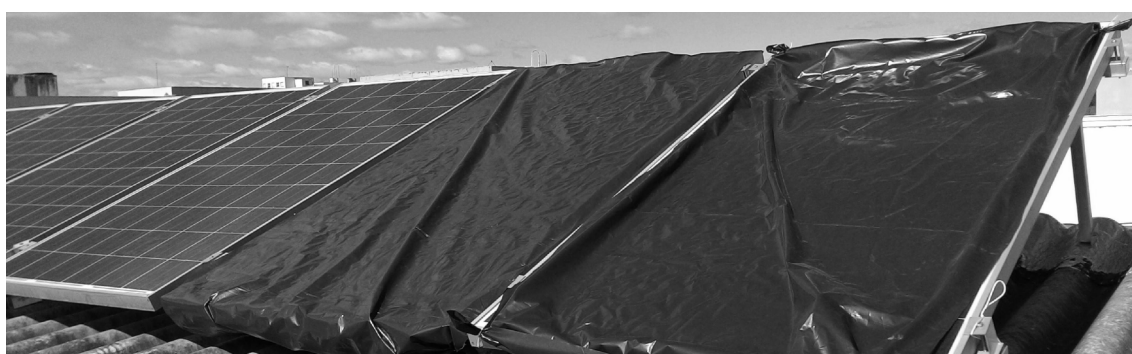
Figura 4.21 – Sombreamento forçado aplicado em dois módulos fotovoltaicos.
