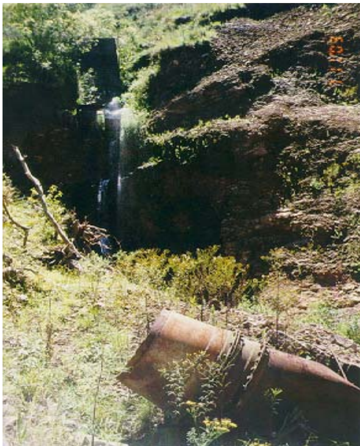
FIGURA 01: Aspecto do dano causado pelo rompimento da canalização.
