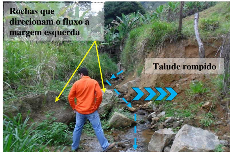
Figura 4.12 – Rochas que direcionam o fluxo a margem esquerda onde o talude encontra-se rompido.
