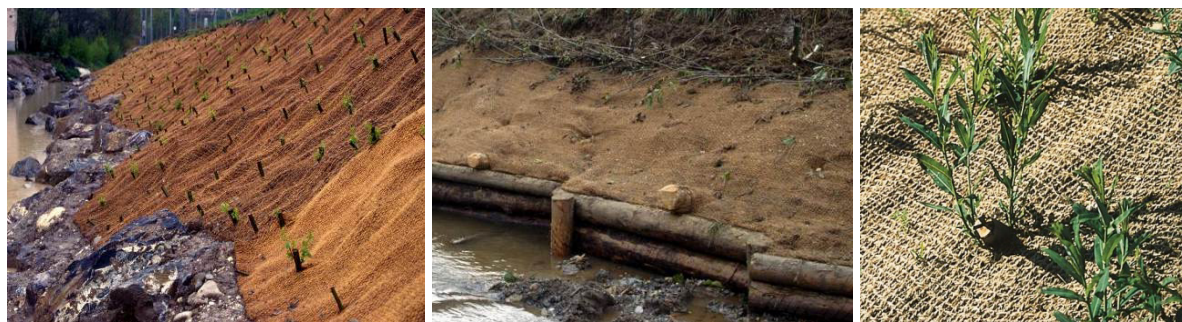
Figura 4.6 – Exemplos da aplicação de biomanta combinada com estaquia vegetativa, base mantida com enrocamento (esquerda), com estrutura de madeira (centro) e detalhe da estaquia (direita).
