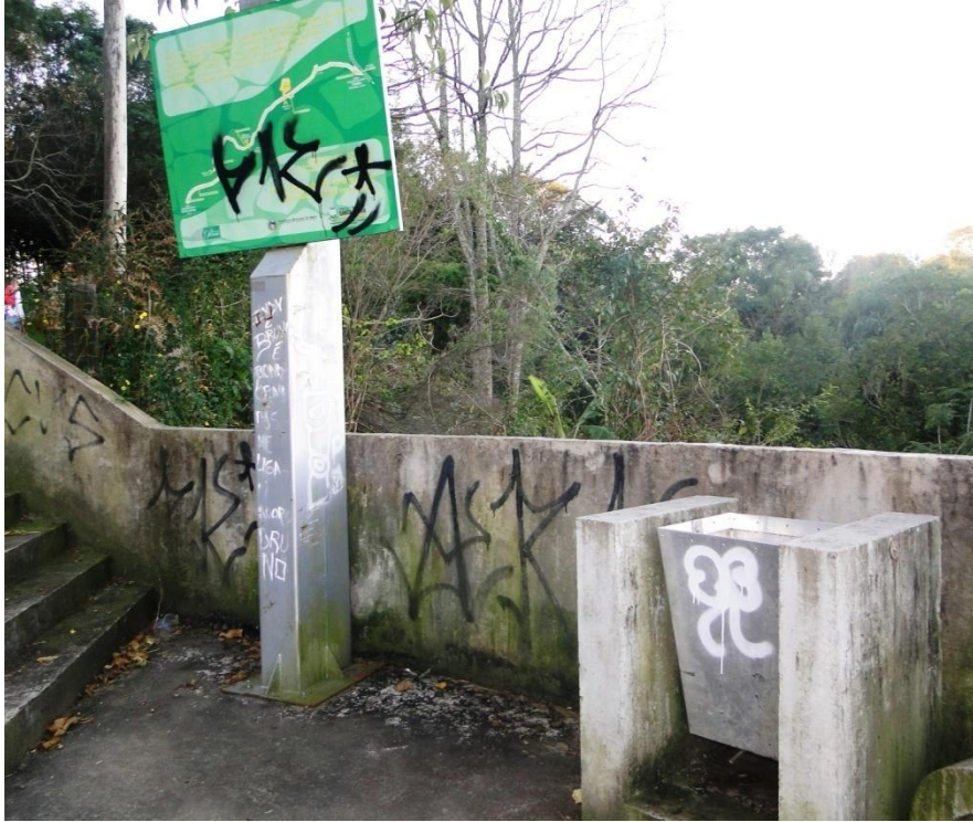
Figura 36 – Patrimônio deteriorado na Estrada do Perau, 2013. Fonte: Pesquisa de campo
