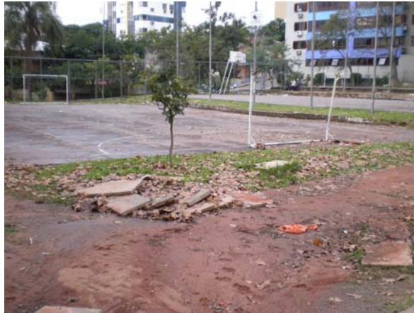
FIGURA 19: Imagem de alagamento no Calçamento do parque.
