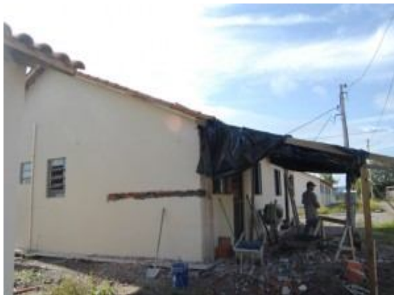
Figura 15- Paredes trincadas em Casa do Loteamento Cipriano da Rocha em Santa Maria/RS Fonte: Jornal A razão, 12 de março de 2009. Organização: PILAR, A. M. R
