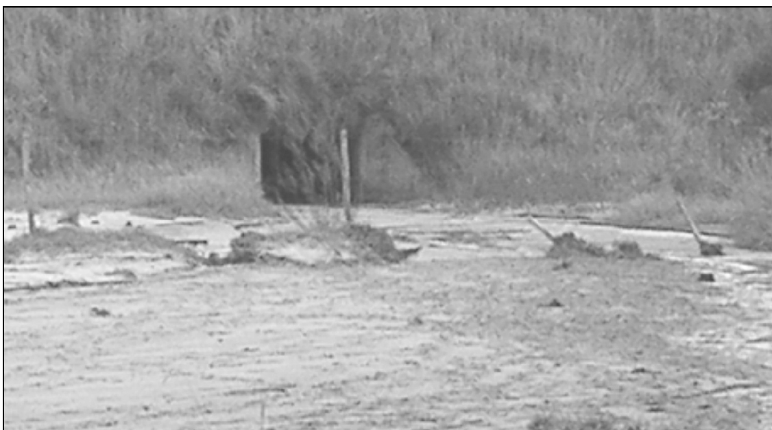
Figura 36: Duto abaixo da estrada e deposição do material retirado das cabeceiras de drenagem.
