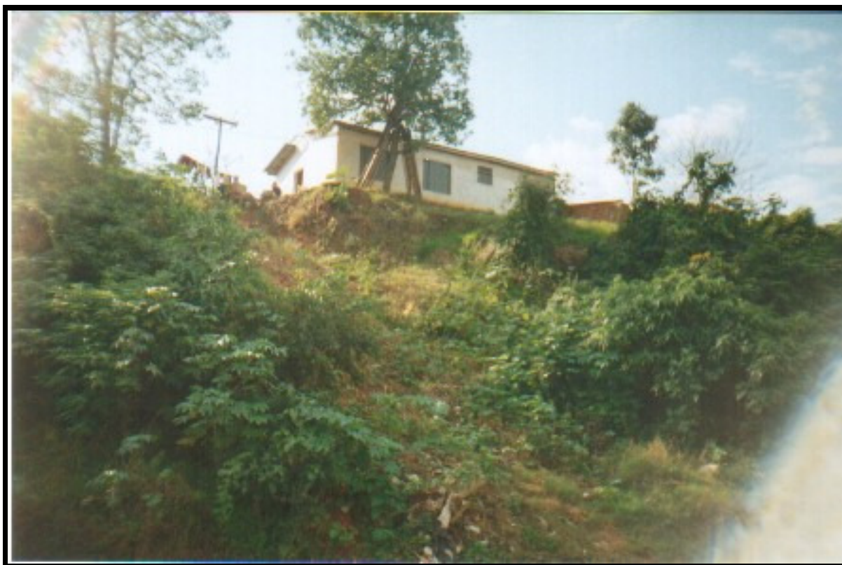
Figura 33 - Área da encosta Itagiba que está assentada sobre a Formação Santa Maria – Membro Alemoa, mostrando intenso ravinamento e formação de sulcos. Org.: MARQUES, R. D.
