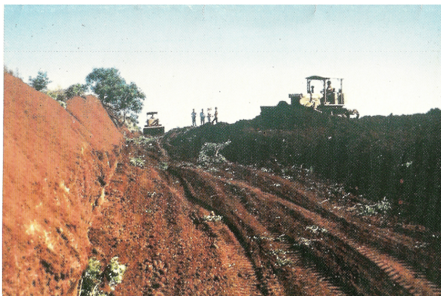
Figura 08: trabalho de rebaixamento dos taludes para inserção de base larga. Fonte: Folder EMATER/COTRIJUÍ, 1992.
