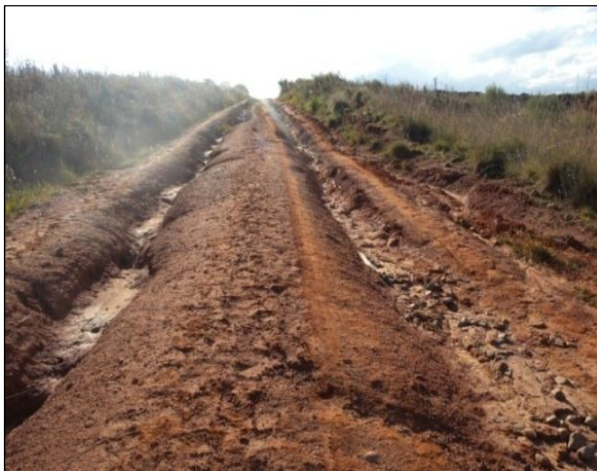
Figura 48 - Sulcos e ravinas desenvolvidos em estrada sobre material de alteração.
