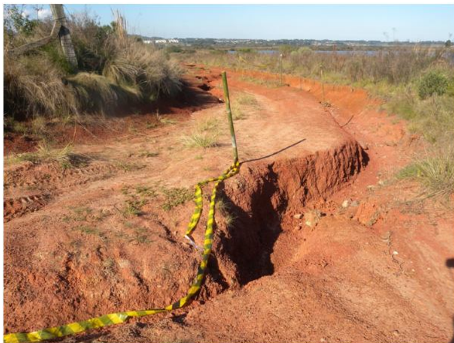
Figura 46 - Erosão no limite da estrada entre o CIBLD e o CISM.
