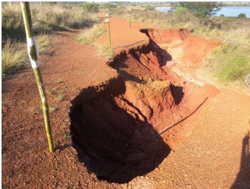
Figura 47 - Erosão em ravinas originada pelo fluxo d'água superficial no encontro de duas estradas.
