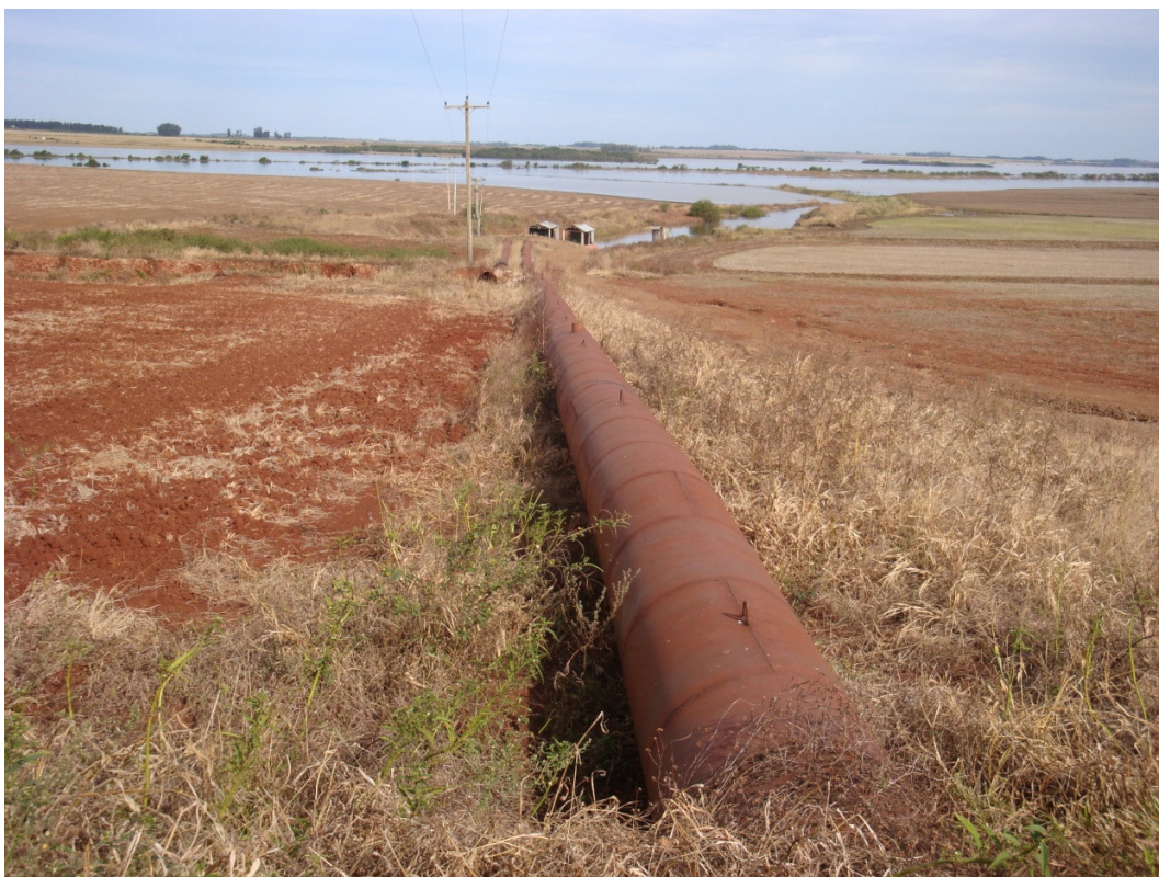
Fotografia 18 – Irrigação de levante, feita através de largos canos que conduzem a água de um terreno mais baixo para um terreno mais elevado.
