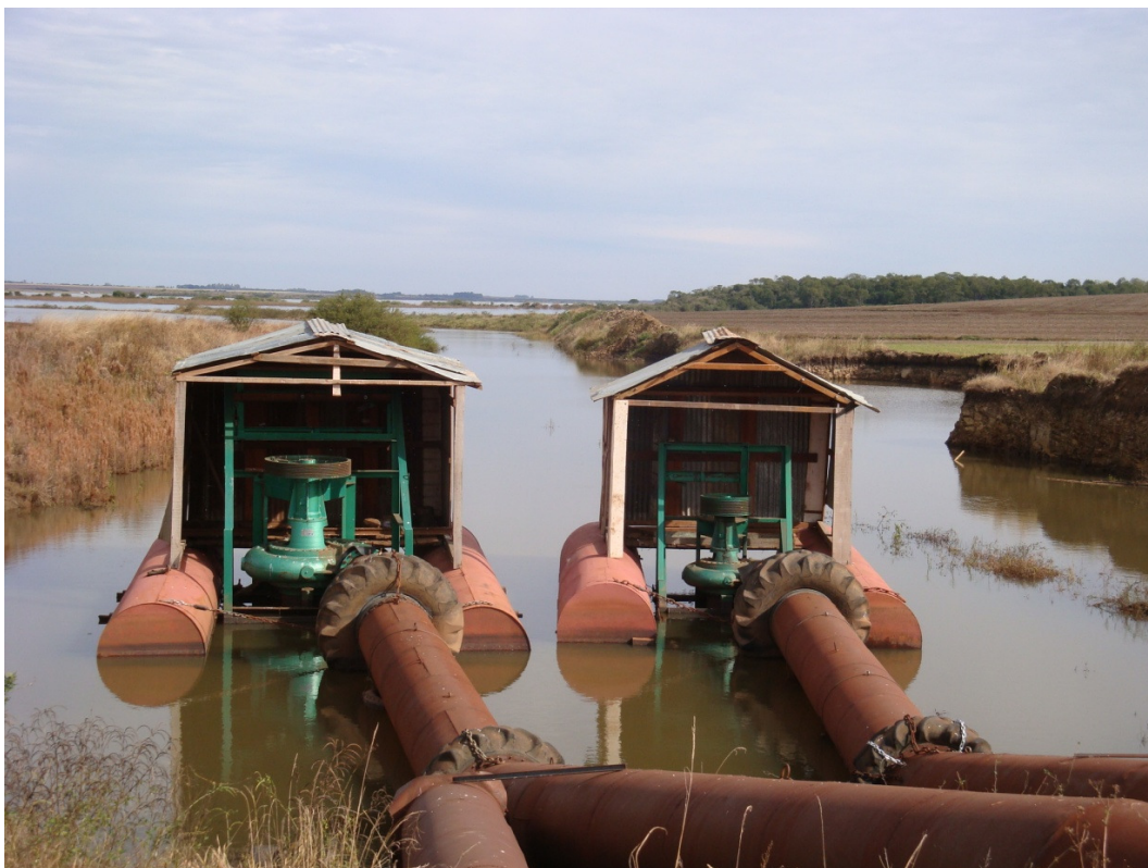
Fotografia 19 – Casa das bombas e motores, que possibilitam que a água bombeada suba oposta à gravidade de forma a ser conduzida por dentro dos levantes até chegar a terrenos mais elevados.
