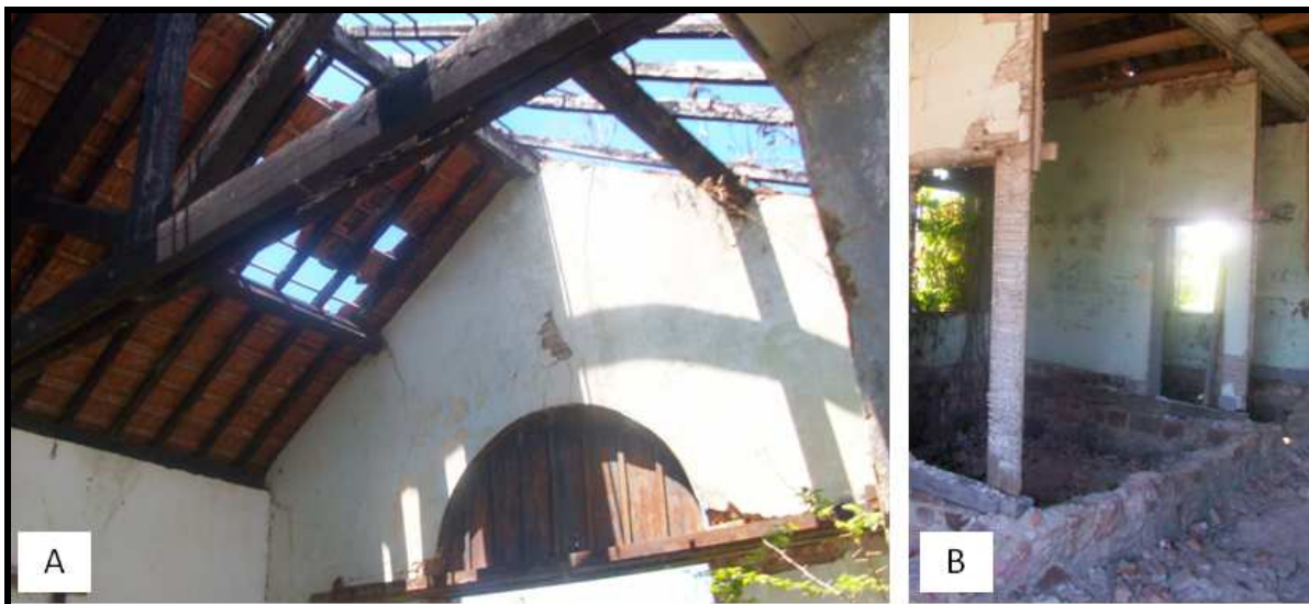
Figura 23: Fotografia A e B demonstram a depredação interna da antiga estação ferroviária da Estiva. Salienta-se que as janelas, telhas, portas, piso foram furtados.
