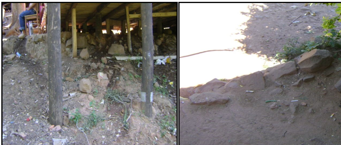
Figura 11: Blocos de rochas dispersas sobre o solo, evidenciando movimentos de massa no local.
