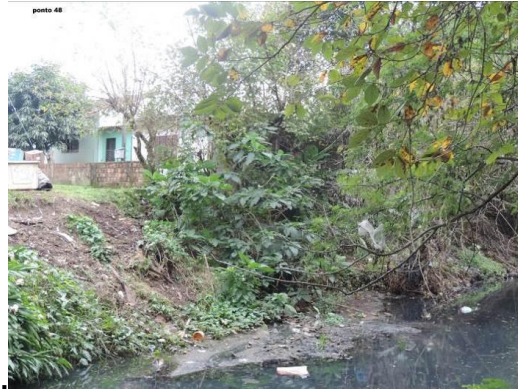
Figura 18 - Fotografia da moradia 48, localizada na margem do rio Vacacaí Mirim. Margem com processo erosivo e com acúmulo de lixo.
