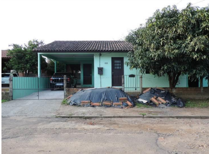
Figura 26 - Fotografia da moradia 01A com histórico de inundação.
