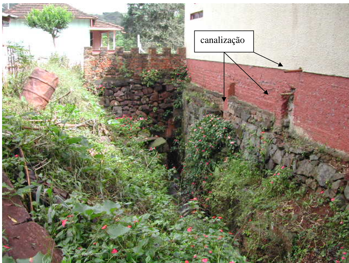
FIGURA 3 - Dejetos domésticos e sanitários canalizados diretamente para o curso do Lajeado da Represa.
