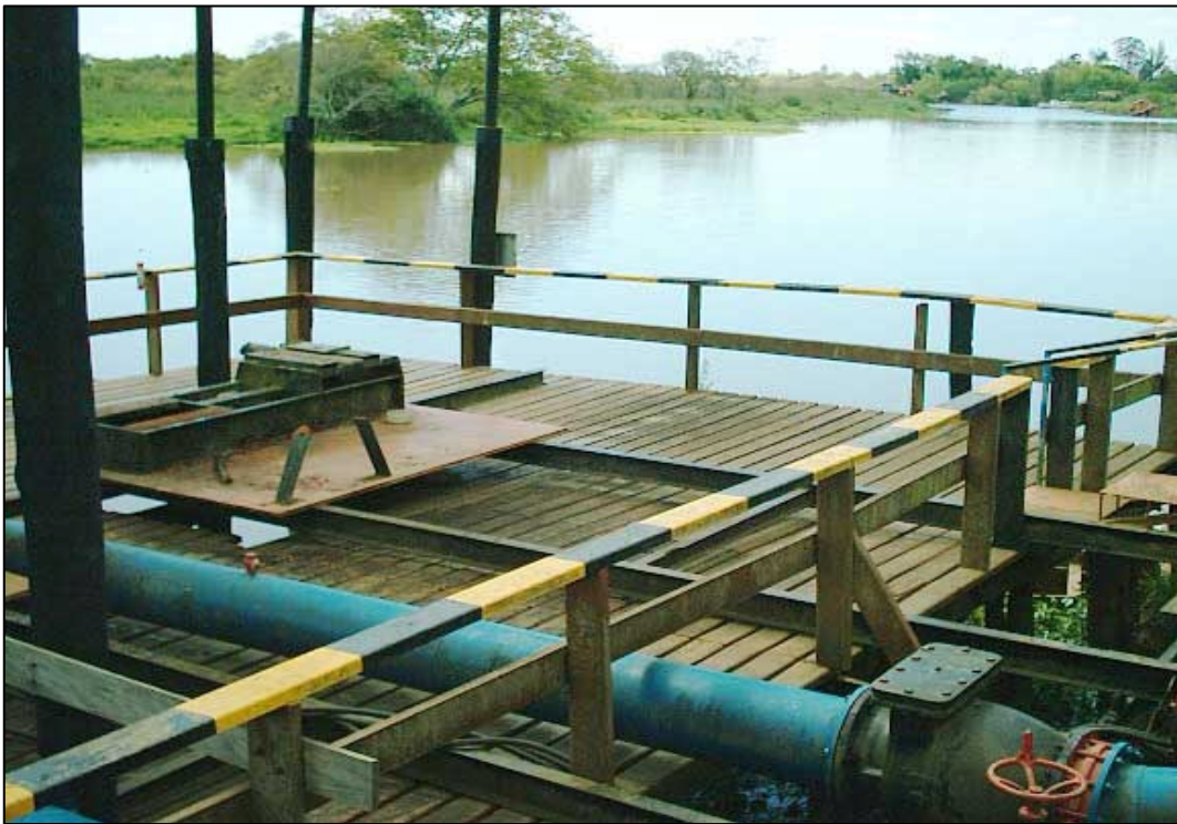
Foto 04: Estação de Captação de Água vista dos equipamentos. Data: 21/10/2003.
