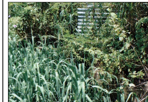
Local do lançamento dos esgotos que saem da ETE sem tratamento. Vala da Av. Irineu C. de Braga. Data: 20/02/04.
