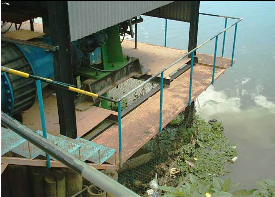
Foto 05: Detalhe do ponto de captação de água da EBA-03. Data: 21/10/2003.
