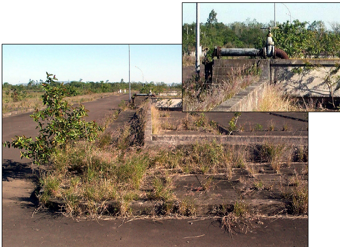
Foto 15: Leitos de secagem do lodo de esgoto. Como a estação de tratamento não tem executado o tratamento de esgotos a pleno, os leitos de secagem do lodo de esgoto, (resíduo do tratamento) permanecem sempre secos. Data: 15/10/2003.
