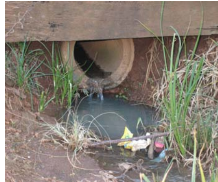
Figura 27 - Esgoto a céu aberto
