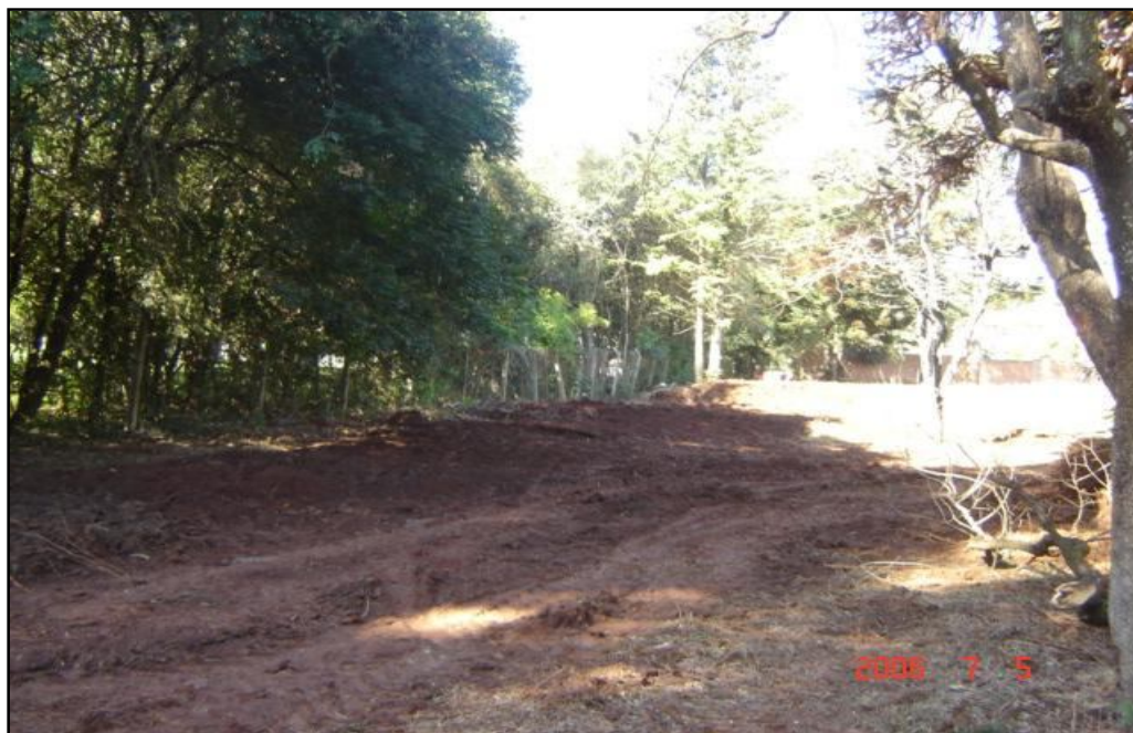
Figura 24: Supressão da vegetação ciliar, Bairro Garibaldi Fonte: Trabalho de campo
