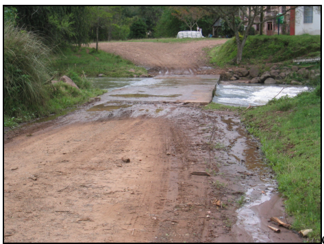
Estrada rural no interior do município de Faxinal do Soturno, pontilhão: Estado de conservação: ruim
