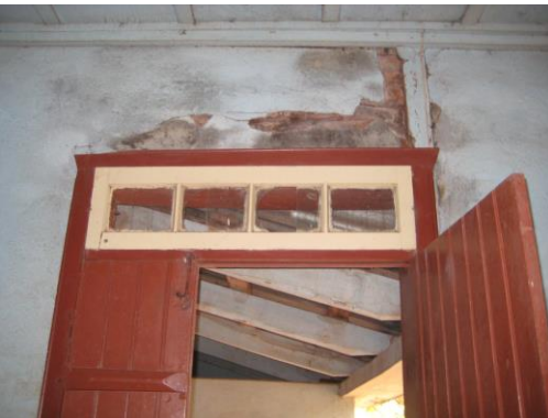
Paredes internas com grandes rachaduras
