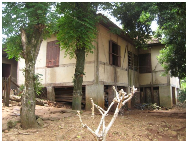
Figura 23: Pilares de tijolos maciços substituem os antigos pilares de madeira - Residência Theisen. Fonte: A autora, 2014.
