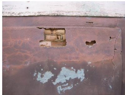
Reboco de barro degradado
