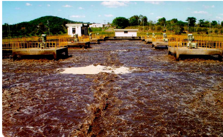
FIGURA 10 – Tanque de aeração de ETE de sistema de Lodo Ativado em Santa Maria – RS
