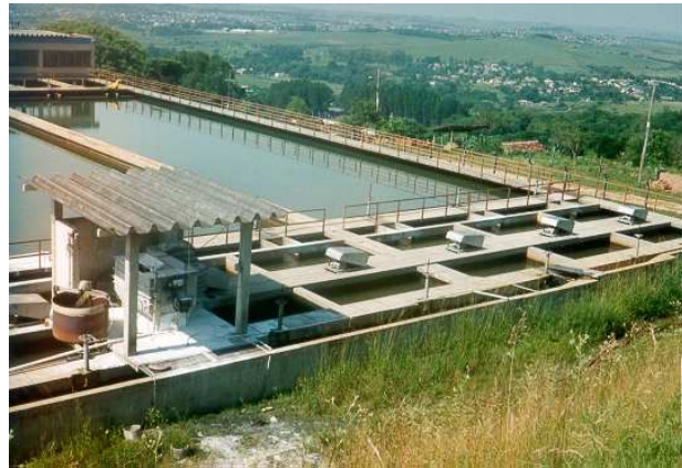
FIGURA 3 – Fotografia do Floculador da ETA de Santa Maria - RS
