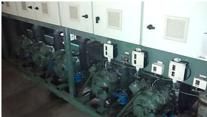
Figura 9 – Sistemas de racks paralelo instalados na central de refrigeração.
