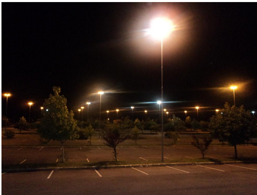
Figura 15 - Sistema de iluminação do estacionamento do Campus
