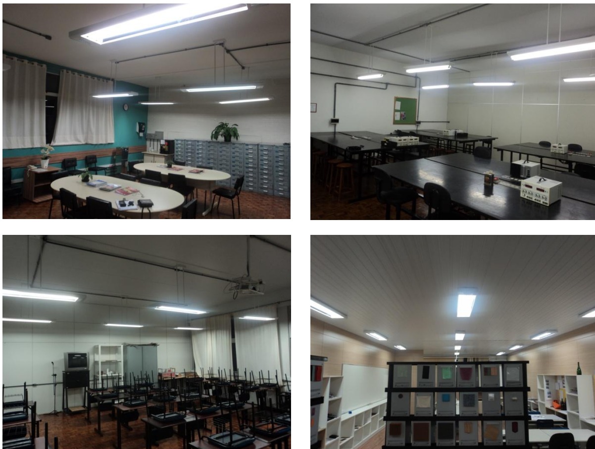
Figura 10 - Fotos do sistema de iluminação do prédio correspondente ao Bloco CD.
