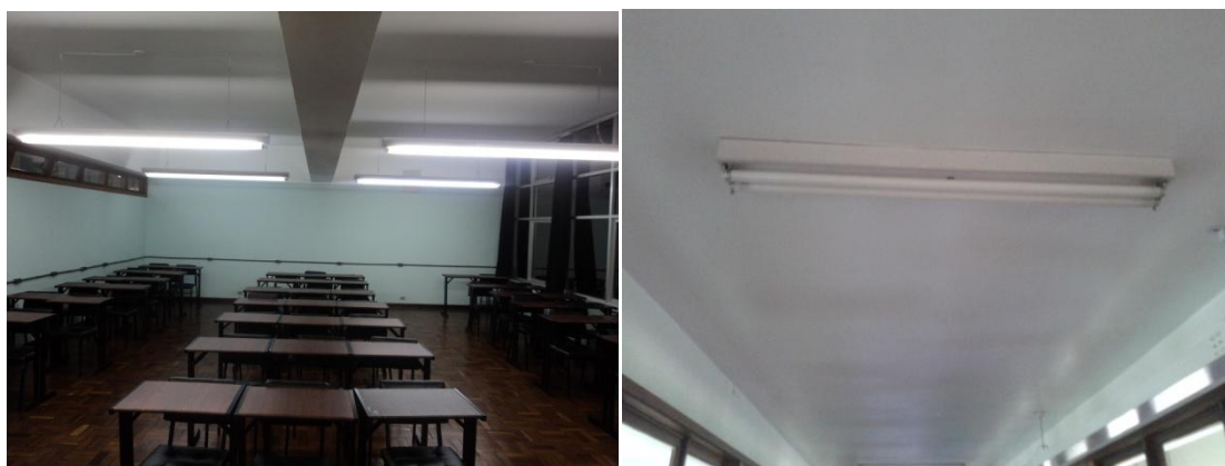
Figura 7 - Fotos do sistema de iluminação do prédio correspondente ao Bloco A.
