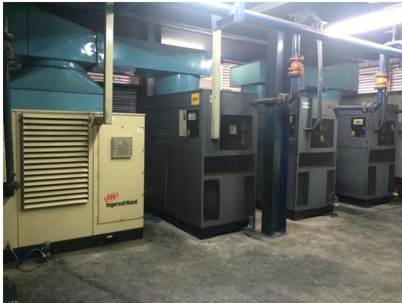
Figura 7 – Disposição dos compressores de ar.
