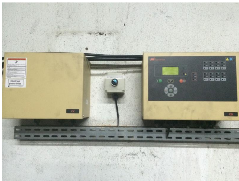
Figura 9 – Gerenciador de ar comprimido X8I e módulo VX Ingersoll Rand.
