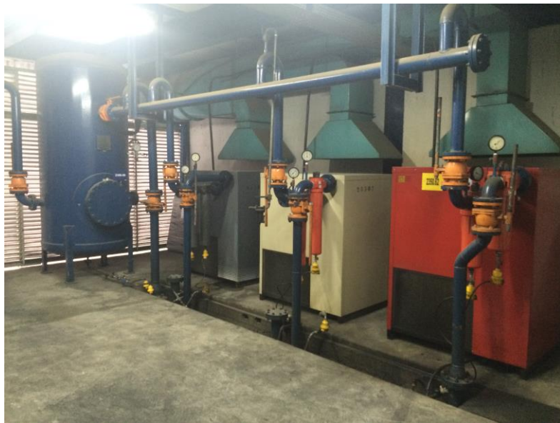
Figura 8 – Disposição dos secadores de ar e reservatório.
