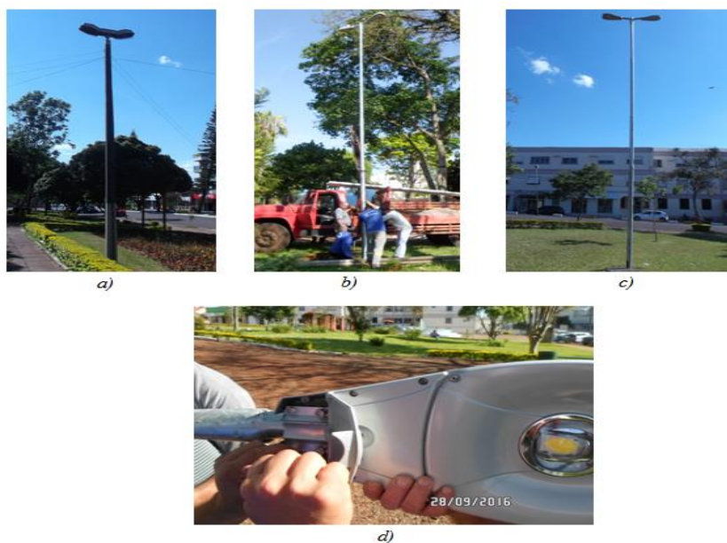
Figura 33 - Implantação das luminárias LED
