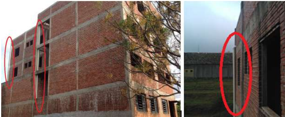
Figura 5- Canais de transporte da água do telhado.
