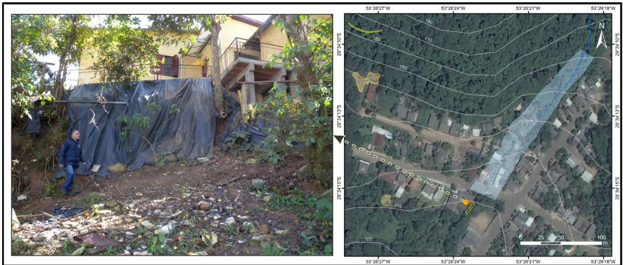
Figura 29 - Situação (II) de perigo alto em área de corte com intervenções estruturais.
