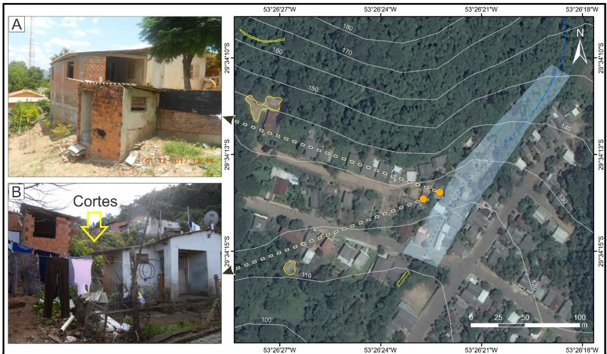
Figura 31 - Situação (IV) de perigo alto com intervenções antrópicas de corte e aterro suscetível a escorregamentos (A e B).
