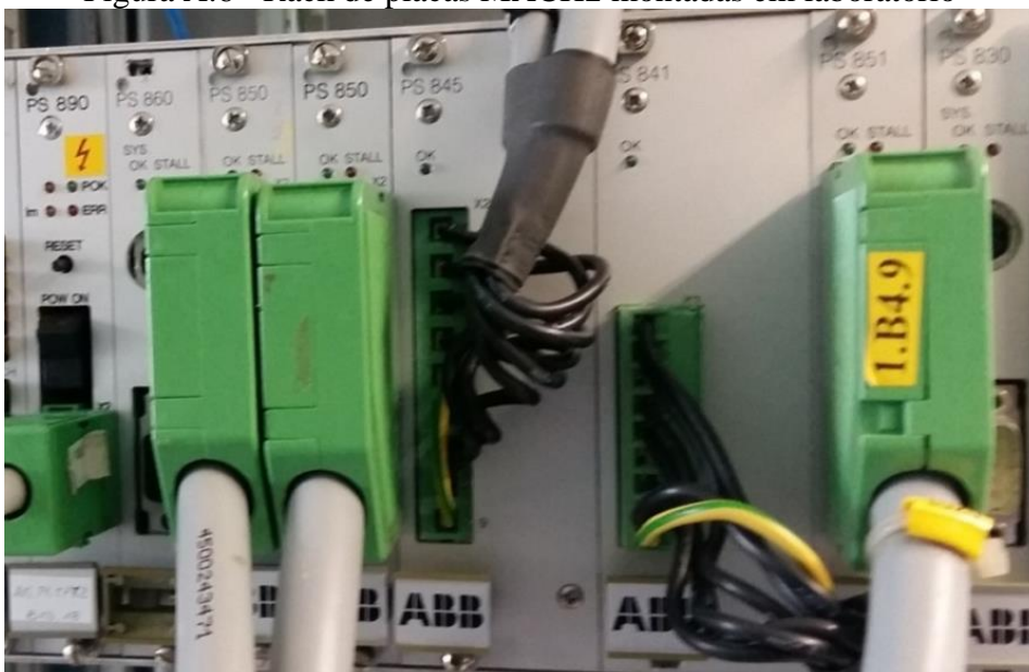
Figura A.6 - Rack de placas MACH2 montadas em laboratório
