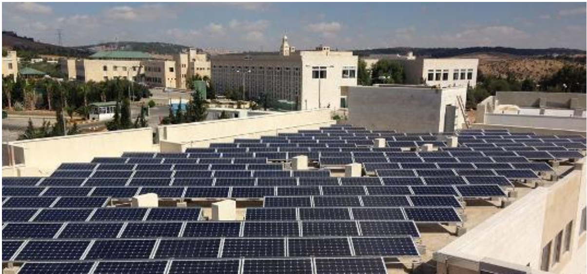
Figura 16 - BAPV com módulos na cobertura em Zaytouna University na Jordânia
