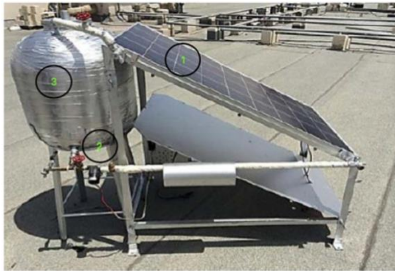
Figura 45 - Sistema FV/térmico híbrido resfriado pela circulação forçada de água
