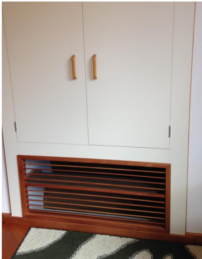
Figura 10 – Duto de entrada de ar nos dormitórios.
