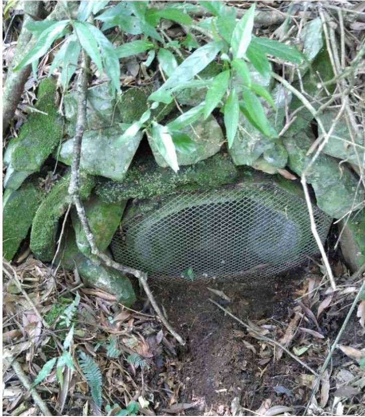
Figura 13 – Entrada externa de ar no duto enterrado.
