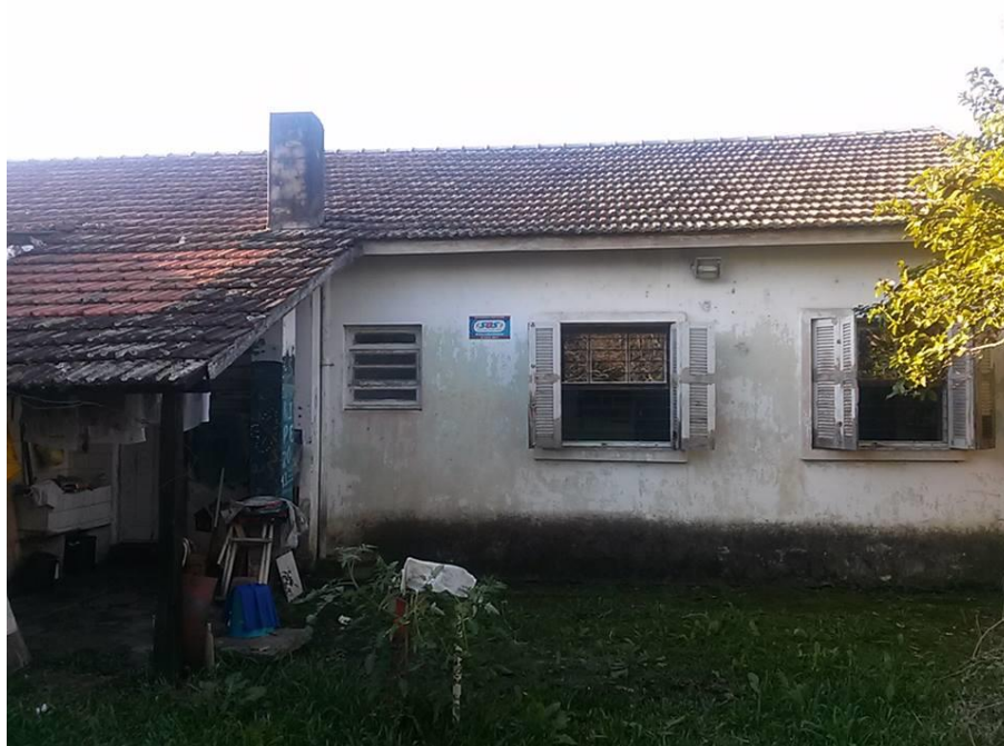
Figura 36: detalhe da deterioração por água e microrganismos no reboco e nas madeiras do telhado. Fonte: Fotos realizadas pelo autor, 2017.
