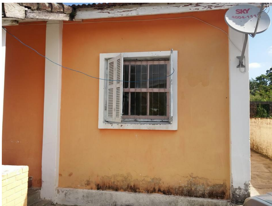
Figura 35: detalhe da deterioração por água e microrganismos no reboco e na madeira Fonte: Fotos realizadas pelo autor, 2017.
